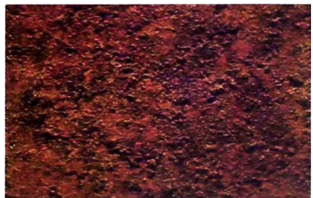
Figura 4.5 – Corrosión grado D.
