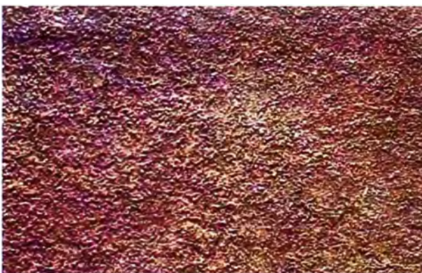
Figura 4.4 – Corrosión grado C.
