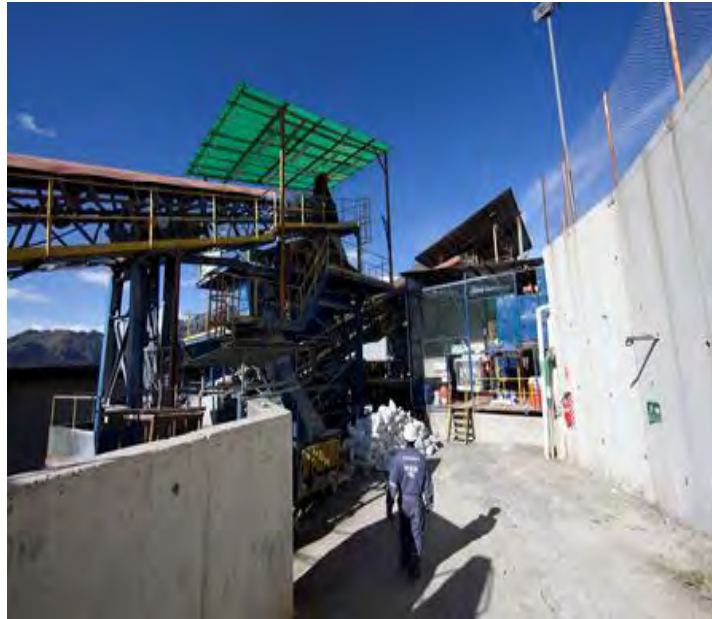
Figura 3.10: Vista de la casa de compresoras
