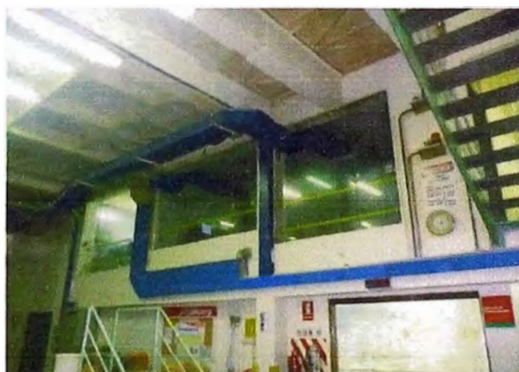
Fig. 5.5 Canaletas existentes a la salida de la sala de control Fuente: Propia
