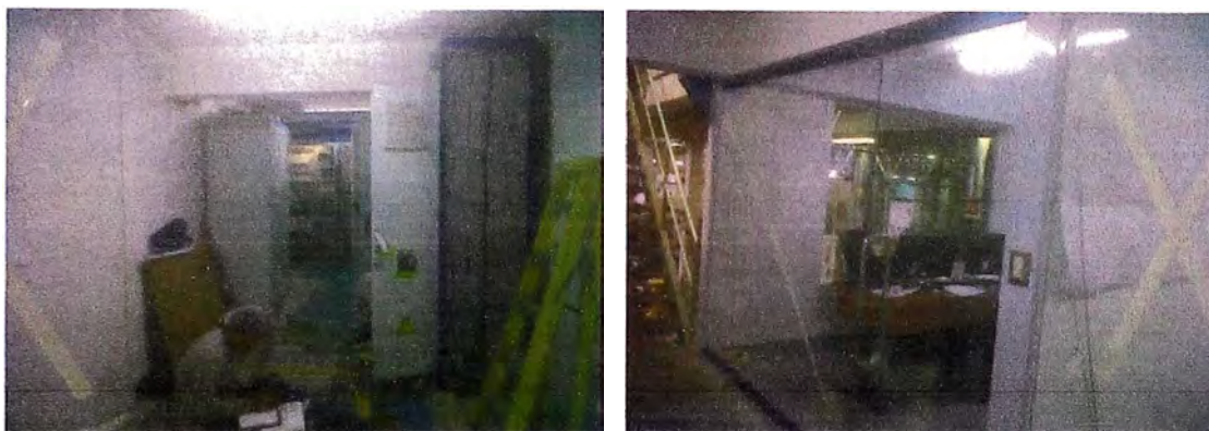
Fig. 5.14 Tableros de distribución, tablero “PLC-3” (izquierda) y nuevo ingreso a la sala de control (derecha)
