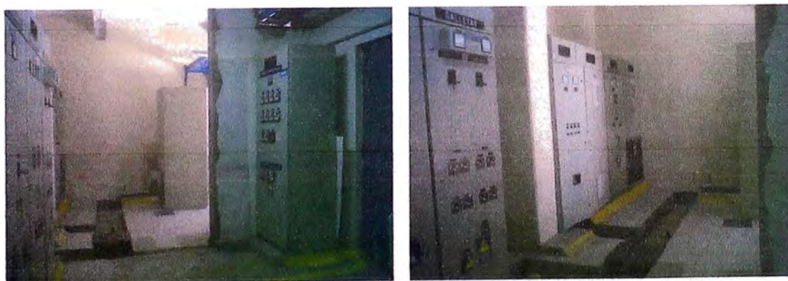
Fig. 5.12 Zanjas y tableros eléctricos de la nueva subestación eléctrica (nueva área) Fuente: Propia
