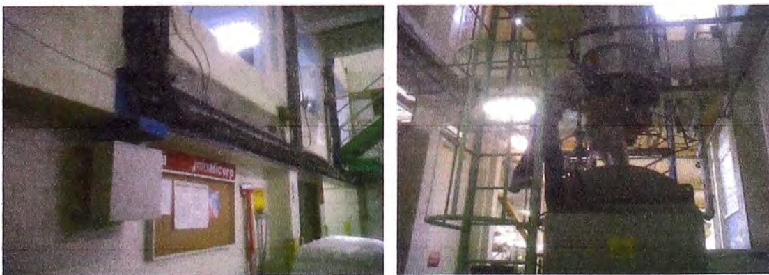
Fig. 5.15 Canalizado a las afueras de la sala de control (izquierda) y conexionado en campo (derecha)
