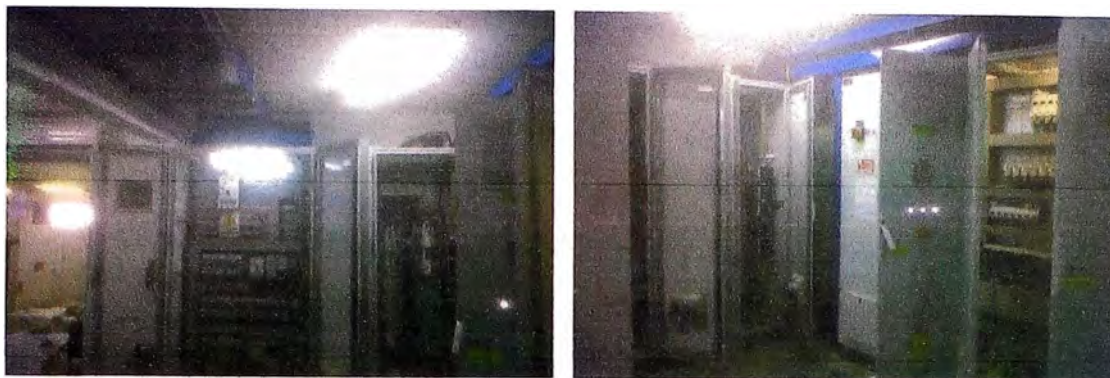
Fig. 5.13 Tablero “PLC-2” reubicado (izquierda) y tablero “PLC-1” (derecha) en la nueva sala de control
