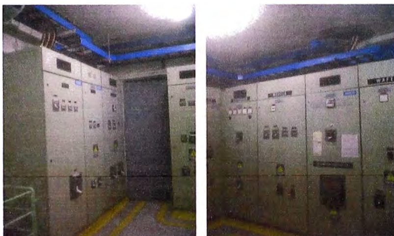
Fig. 5.11 Canaletas y tableros eléctricos de la nueva subestación eléctrica (antigua área) Fuente: Propia
