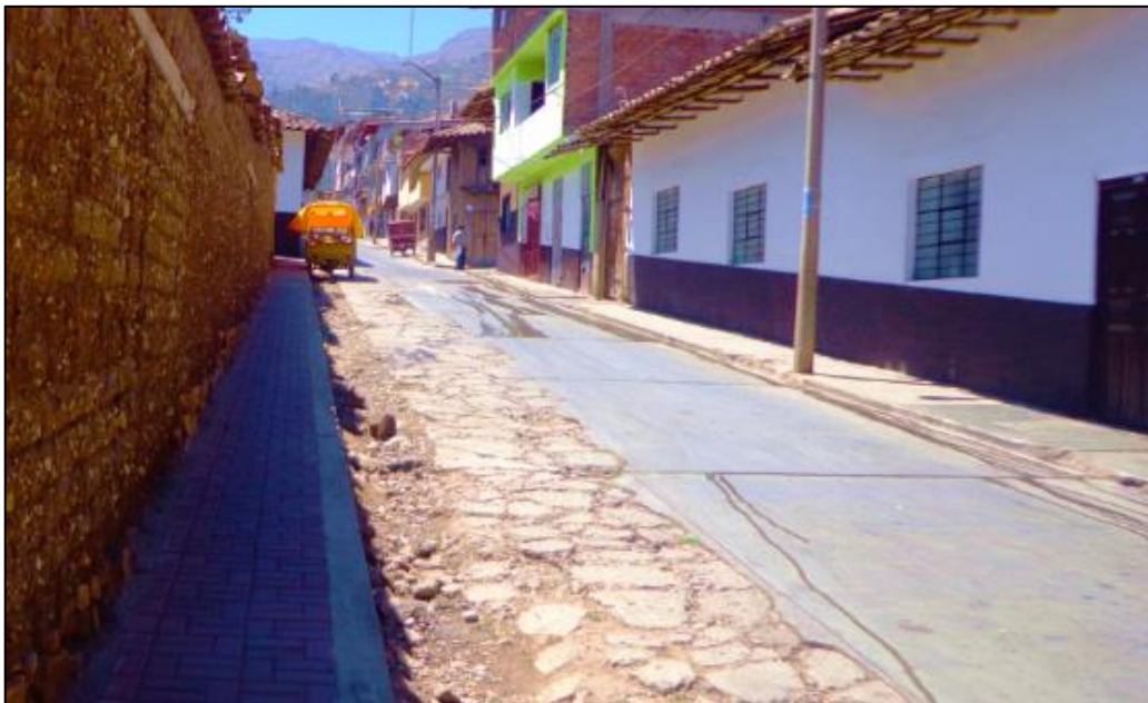
Fotografía 3.1. Erosión en la vía de una calle longitudinal
