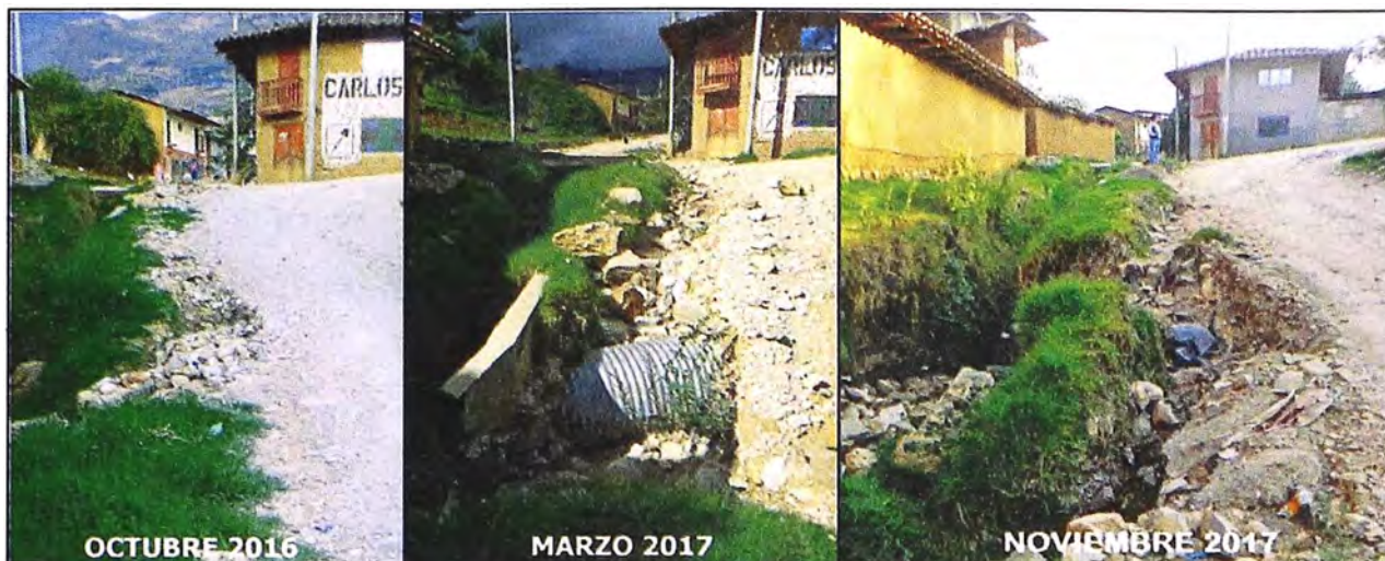
Fotografía A.7. Destrucción constante de la principal vía de comunicación entre la ciudad de Cajabamba y cuatro comunidades (Churrucana, Higosbamba, Hichabamba y Colcas) a causa de la escorrentía superficial de origen pluvial.
