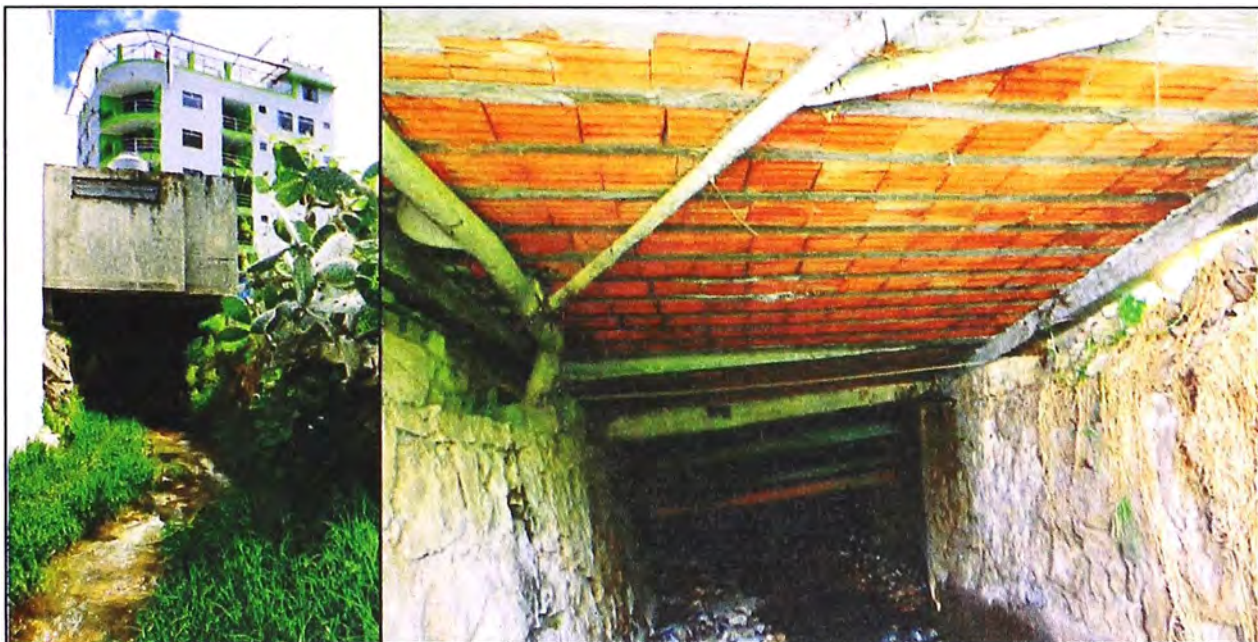
Fotografía A.10. Sobre el cauce de la quebrada Ysmayacu se han construido edificaciones, los cuales convierten al cauce en un tipo de conducto cerrado, presentando un peligro de obstrucción y desborde en diversos tramos importantes de la ciudad.
