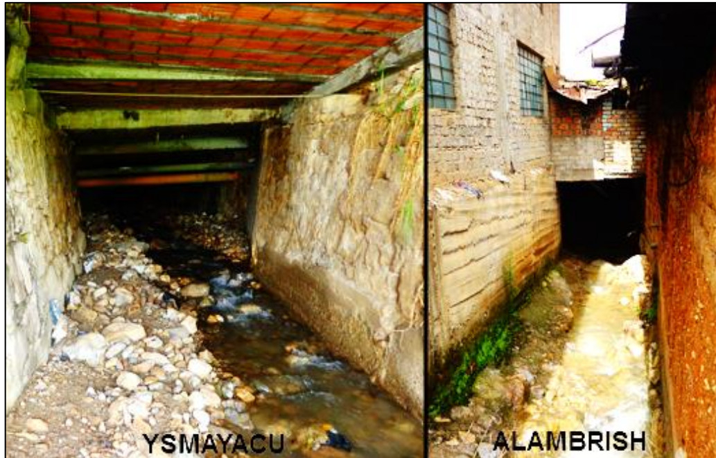
Fotografía 3.5. Edificaciones sobre el cauce de las quebradas Ysmayacu y Alambrish
