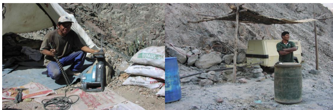
Figura N° 33: Perforadora eléctrica y compresora de martillo artesanal
