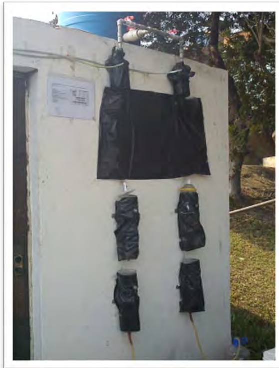
Figura Nº 5.27. Sistema D.H.S. cubierto para evitar el crecimiento de las algas en todo el sistema
