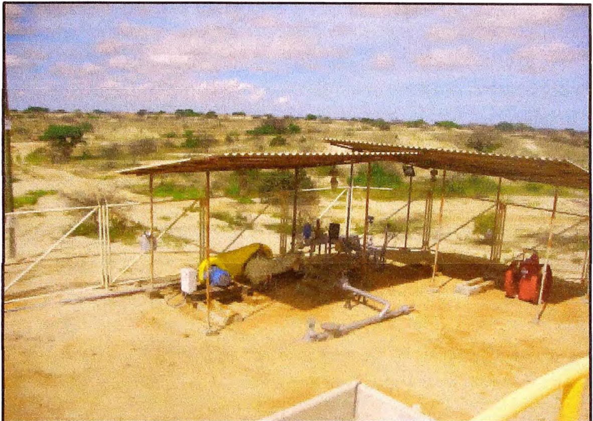
Figura 2.6. Estación de Bombeo de la planta CA-16
