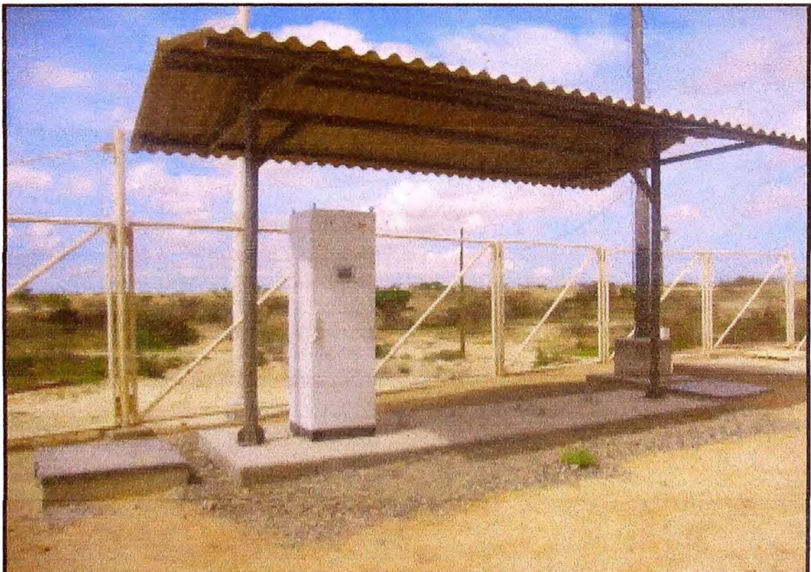
Figura 2.8. Tablero eléctrico y de control existente en la planta.
