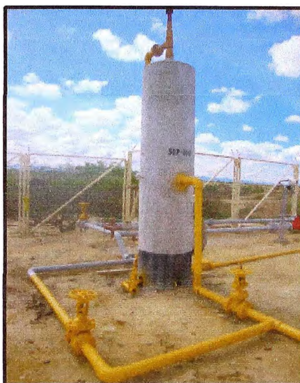
Figura 2.3. Scrubber de gas, existente en la planta.
