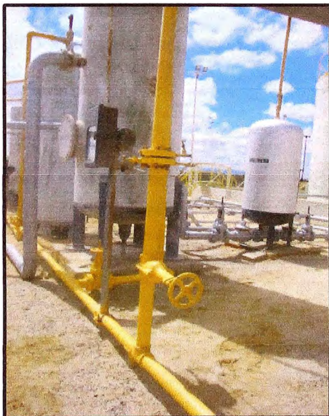
Figura 2.2. Vista de Separador de Totales de la planta.
