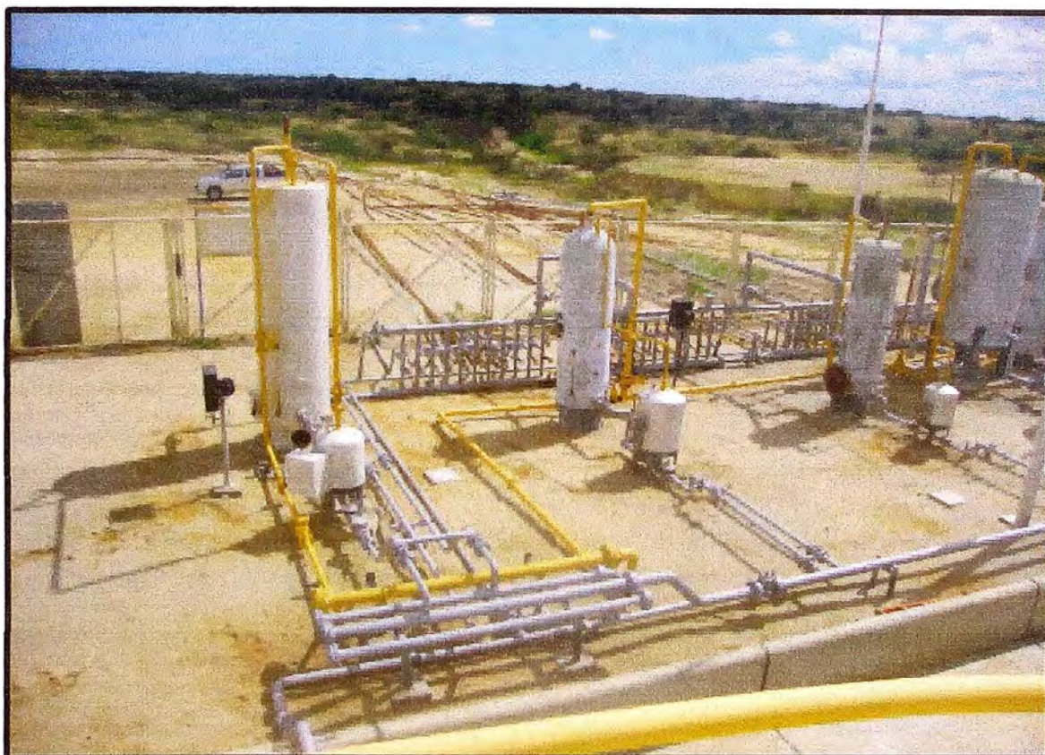
Figura 2.4. En la parte izquierda el Separador de Control SC-1606 y lado derecho el Separador de control SEP-158 inoperativo.
