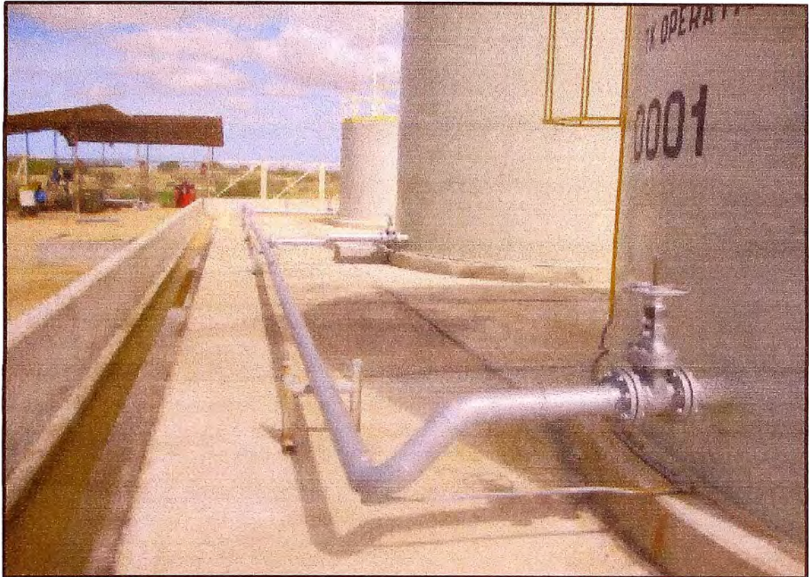
Figura 2.5. Tanques TK-1601, 1602 y 1603.
