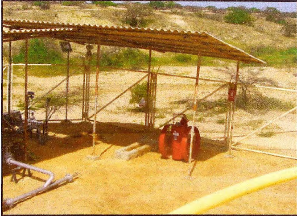
Figura 2.9. Sistema contra incendios de la planta CA-16
