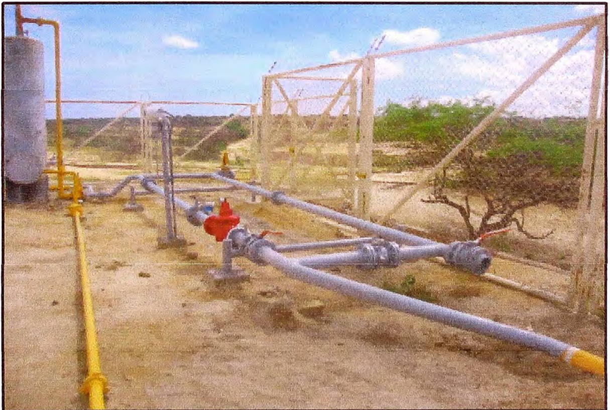
Figura 2.7. Medidor de líquidos a la salida de la planta, conexión con CA-19
