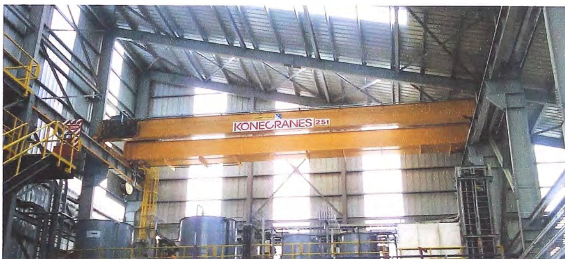
Figura 2.6: Puente grúa de 25 t
