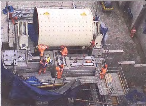
Foto 5: Control topográfico de Alineamiento y Nivelación del soleplate del Sistema de Transmisión del Molino de Barras
