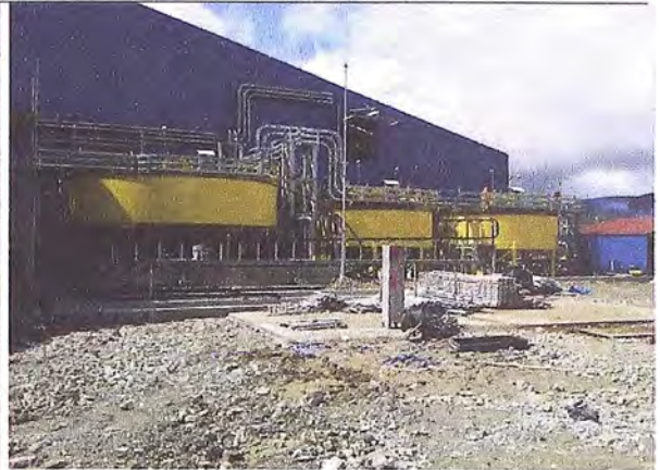
Foto 14: Vista lateral de los Espesadores de Zn, Pb y Cu (De izquierda a derecha)
