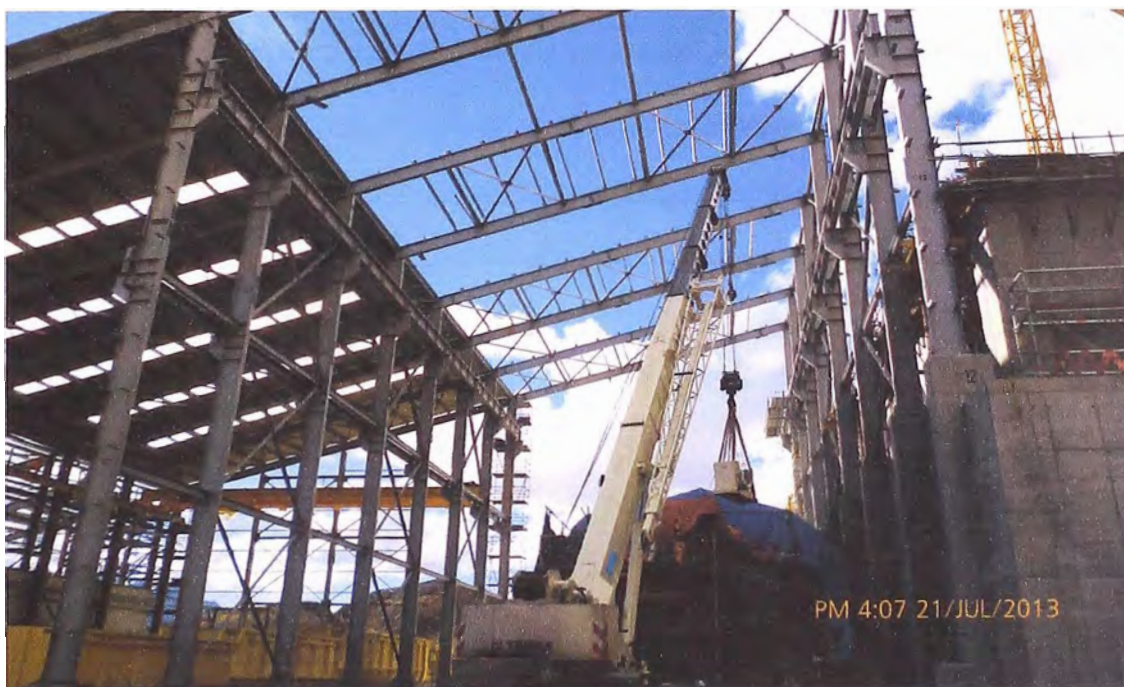
Figura 2.3: Zona de molienda, durante el montaje de chumacera del molino de barras
