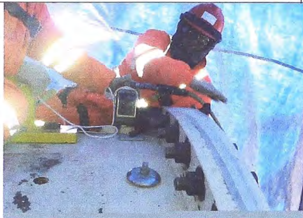
Foto 9: Torqueo de pernos entre el Shell y la tapa de carga del Molino de Bolas con equipo Hytorc
