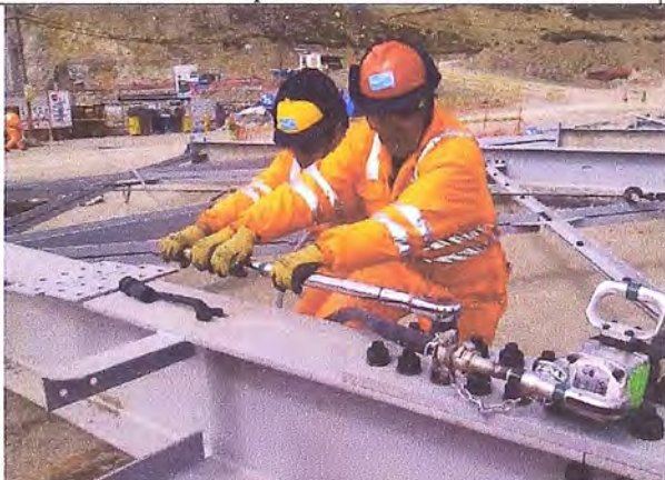
Foto 18: Verificación del torqueo de pernos estructurales de pórticos en la zona de pre-ensamble
