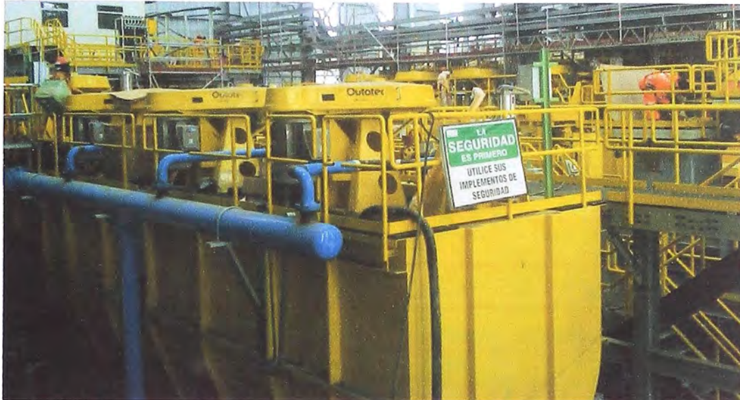
Figura 2.7: Celdas de flotación
