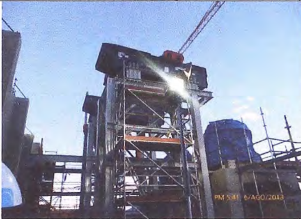
Foto3: Zarandas Vibratorias ubicadas en el área de Chancado Secundario y Terciario
