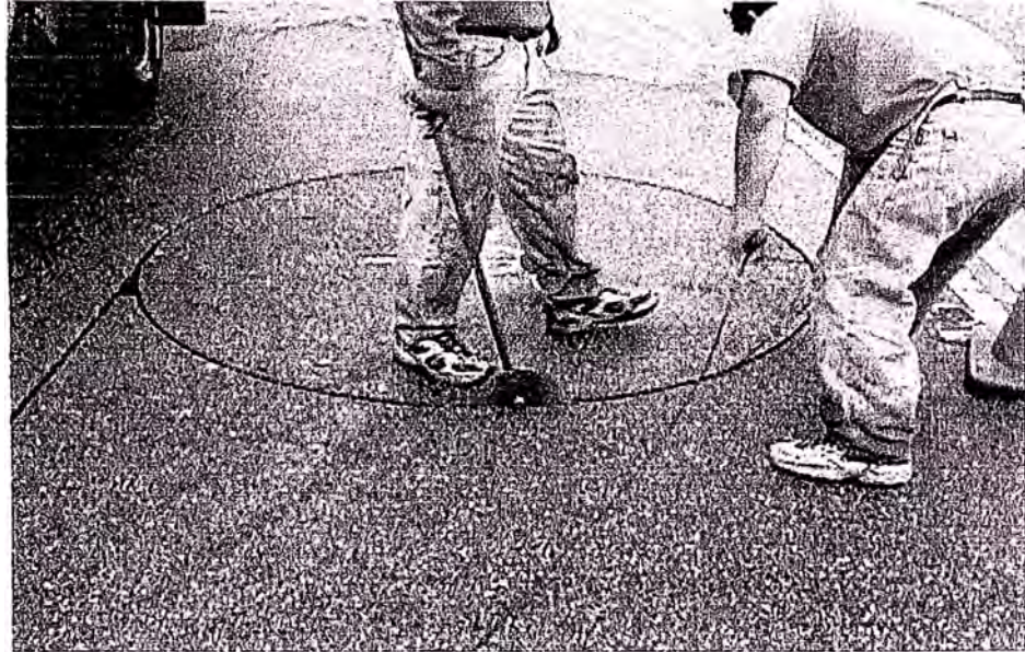
Figura N° 21: Instalación del Conductor del Detector
