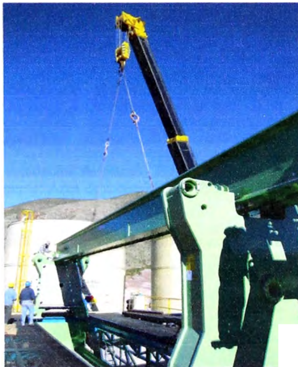
Figura 3.13 Izaje de viga superior - Filtro prensa DIEMME 2000 GHT Fuente: Área de montaje CEMPROTECH SAC.
