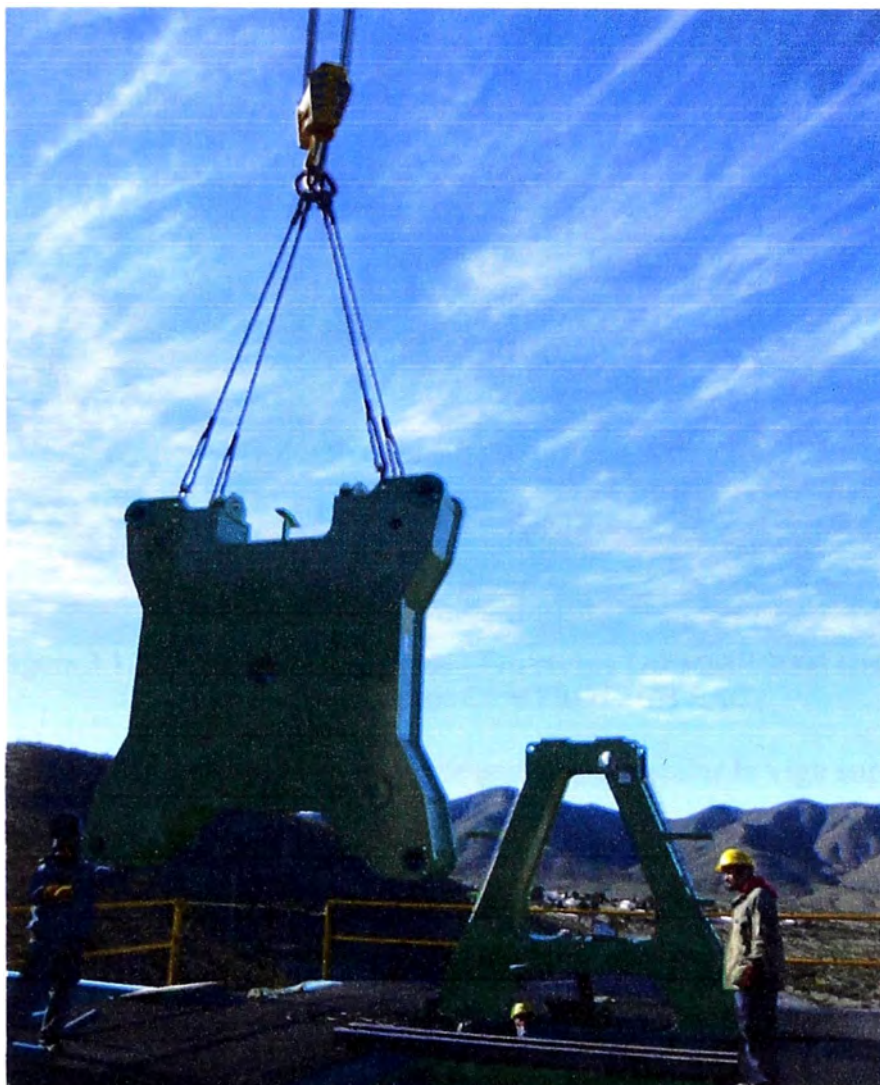
Figura 3.11 Izaje de cabezales de filtro prensa DIEMME 2000 GHT Fuente: Área de montaje CEMPROTECH SAC.
