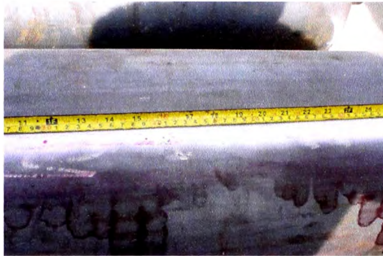
Fig. 4. 37: Cordón de soldadura que presenta porosidades. Fuente: Elaboración propia.
