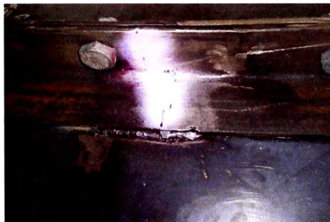
Fig. 4. 36: Cordón de soldadura que presenta fisura.
