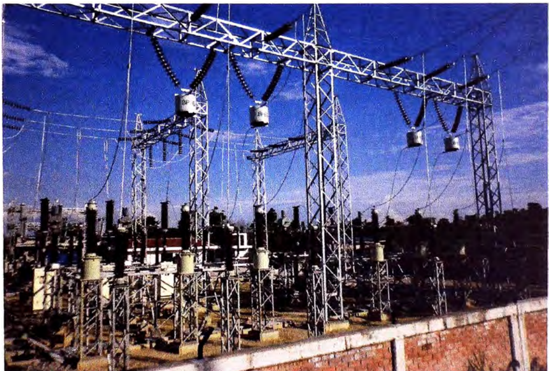
FIGURA N° 1.2.- Subestación Juanjui de 138/22,9/10 kV.
