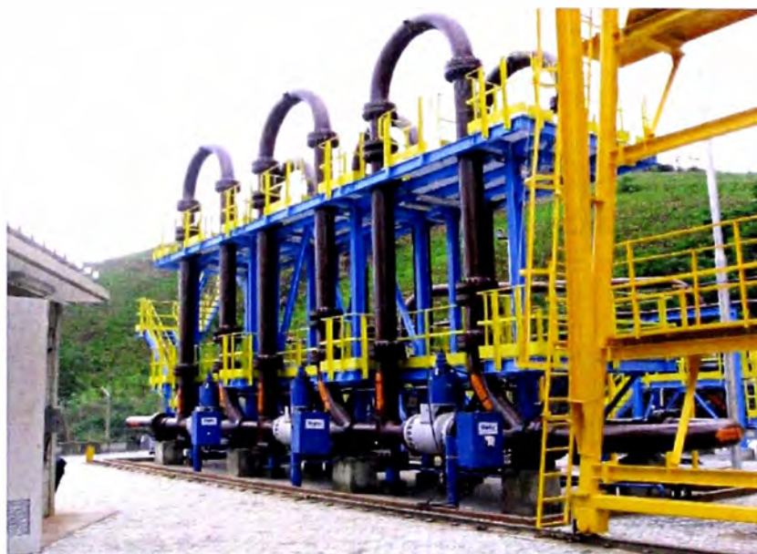
Figura N° 2.25, “Choke station” típica estación de anillos disipadores fijos de presión.
