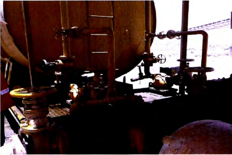
Figura 3-6: Tanque de 12,000 galones
