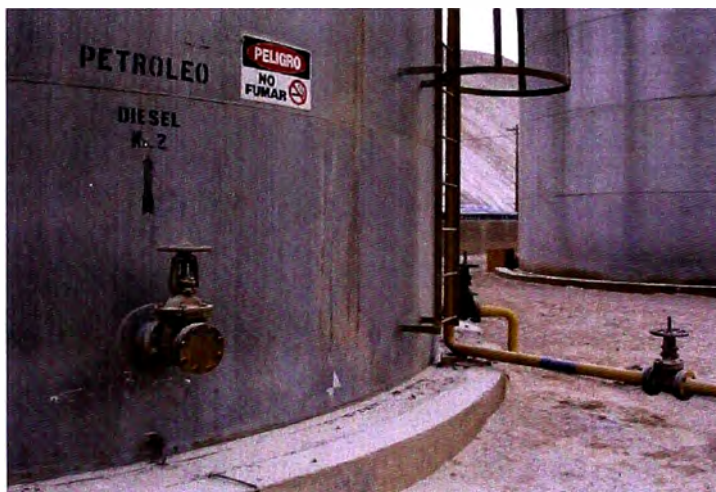
Figura 3-5: Tubería de Ingreso a tanque
