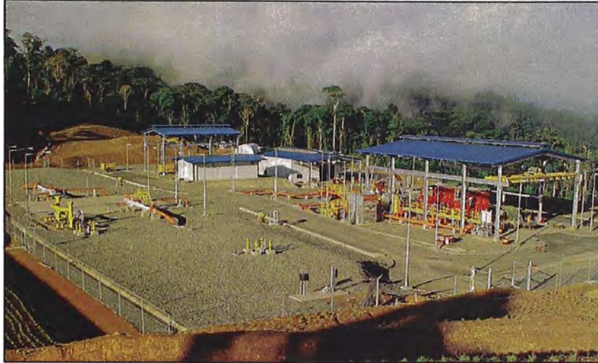
Figura 2.13. Estación de Bombeo de Líquidos N°2 (PS2), TgP.
