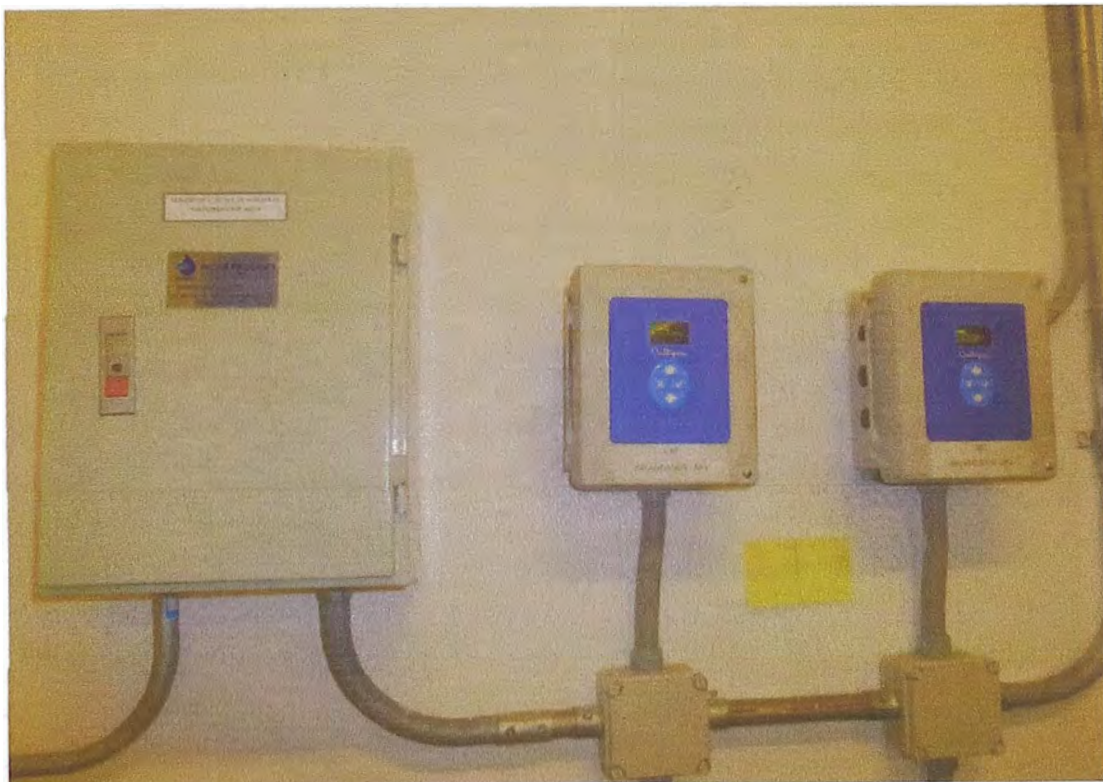
Figura 6.10. Tablero de Control de Planta de Tratamiento de Agua
