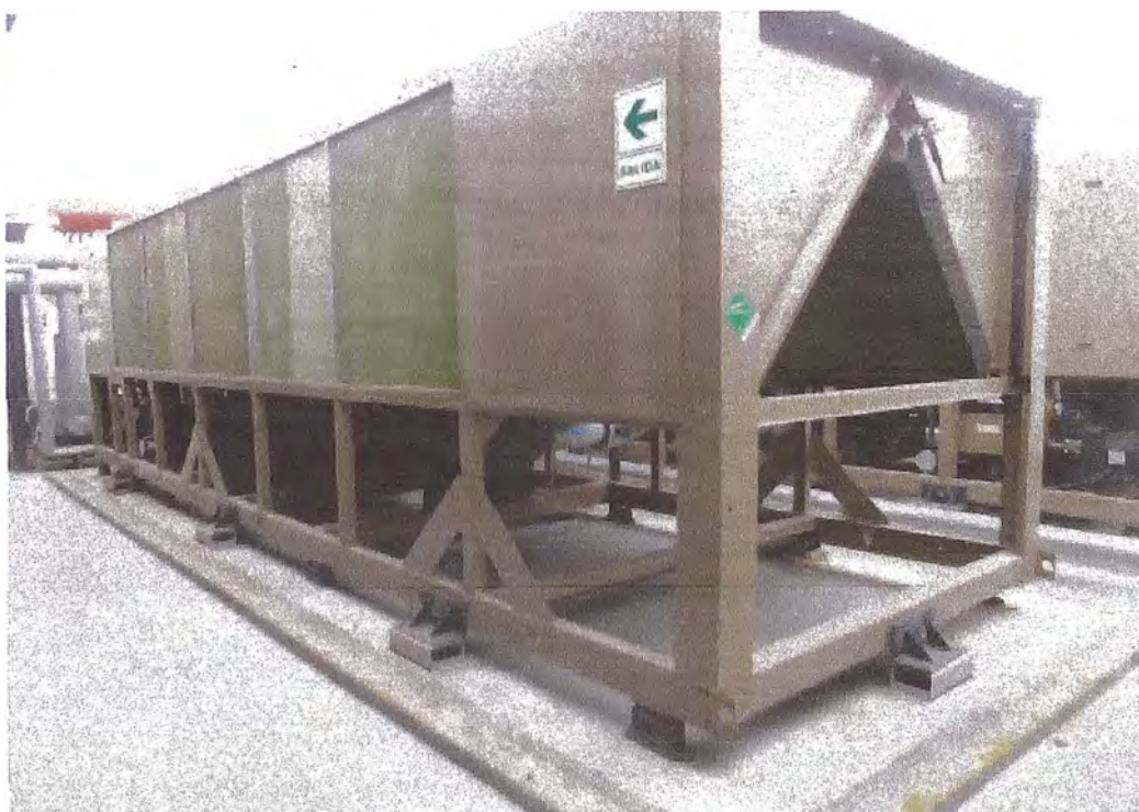
Figura 6.18. Chillers del sistema de climatización
