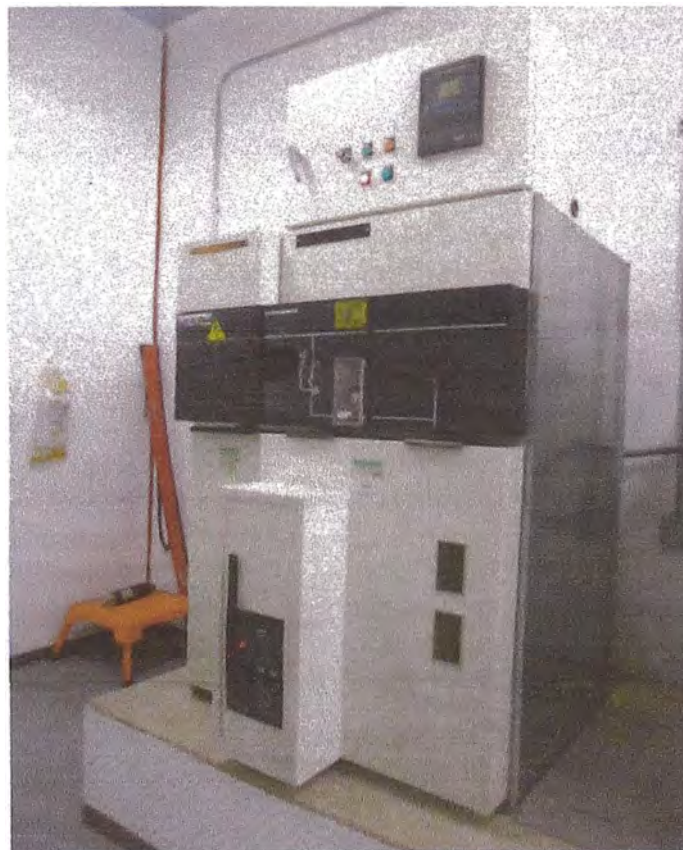
Figura 6.23. Celda de llegada en subestación eléctrica
