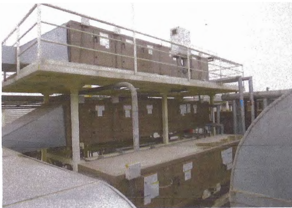
Figura 6.20. Unidades manejadoras de aire del sistema de climatización
