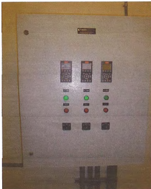
Figura 6.13. Tablero de Control del sistema de bombeo
