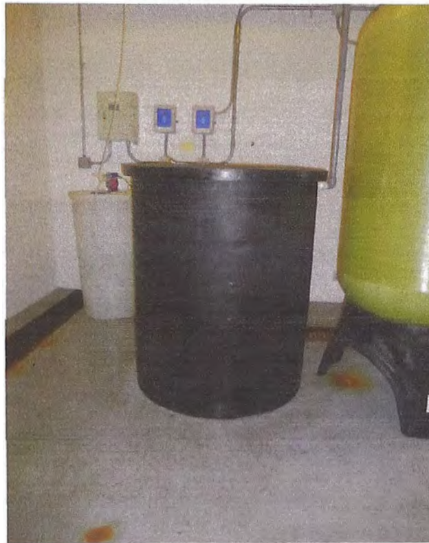
Figura 6.9. Tanque de Salmuera
