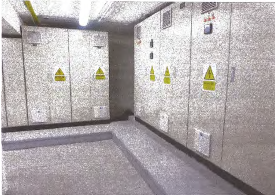
Figura 6.26. Tableros eléctricos de distribución
