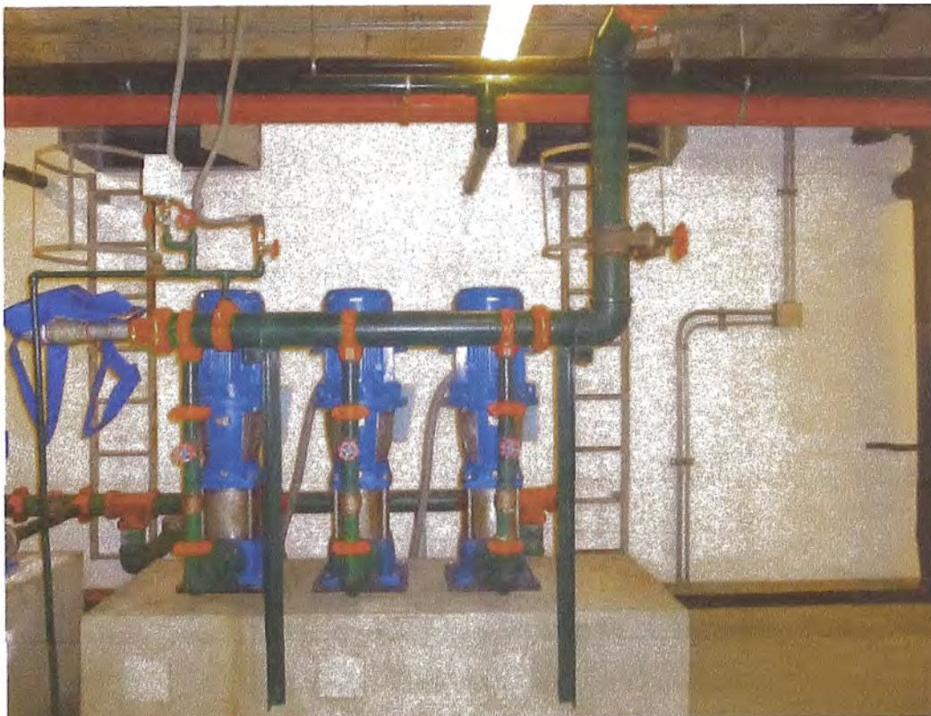
Figura 6.11. Sistema de Bombeo de Agua Dura
