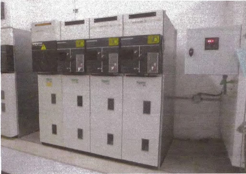
Figura 6.24. Celda de remonte en subestación eléctrica
