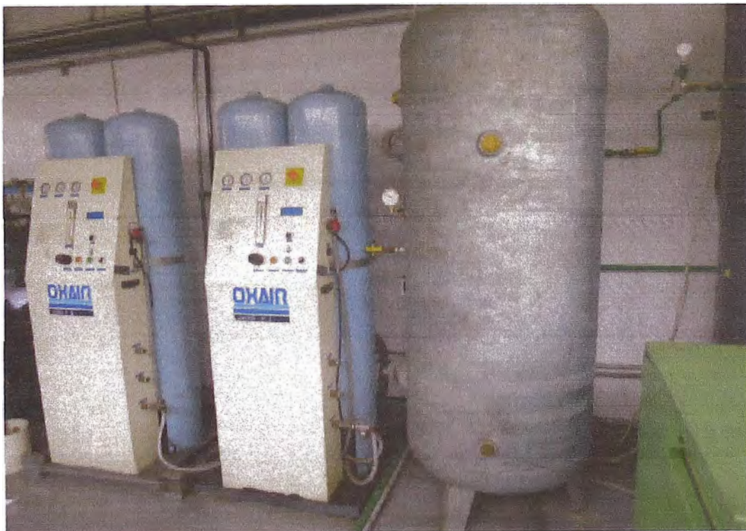
Figura 6.3. Generadores de oxígeno antiguos y tanque de oxígeno
