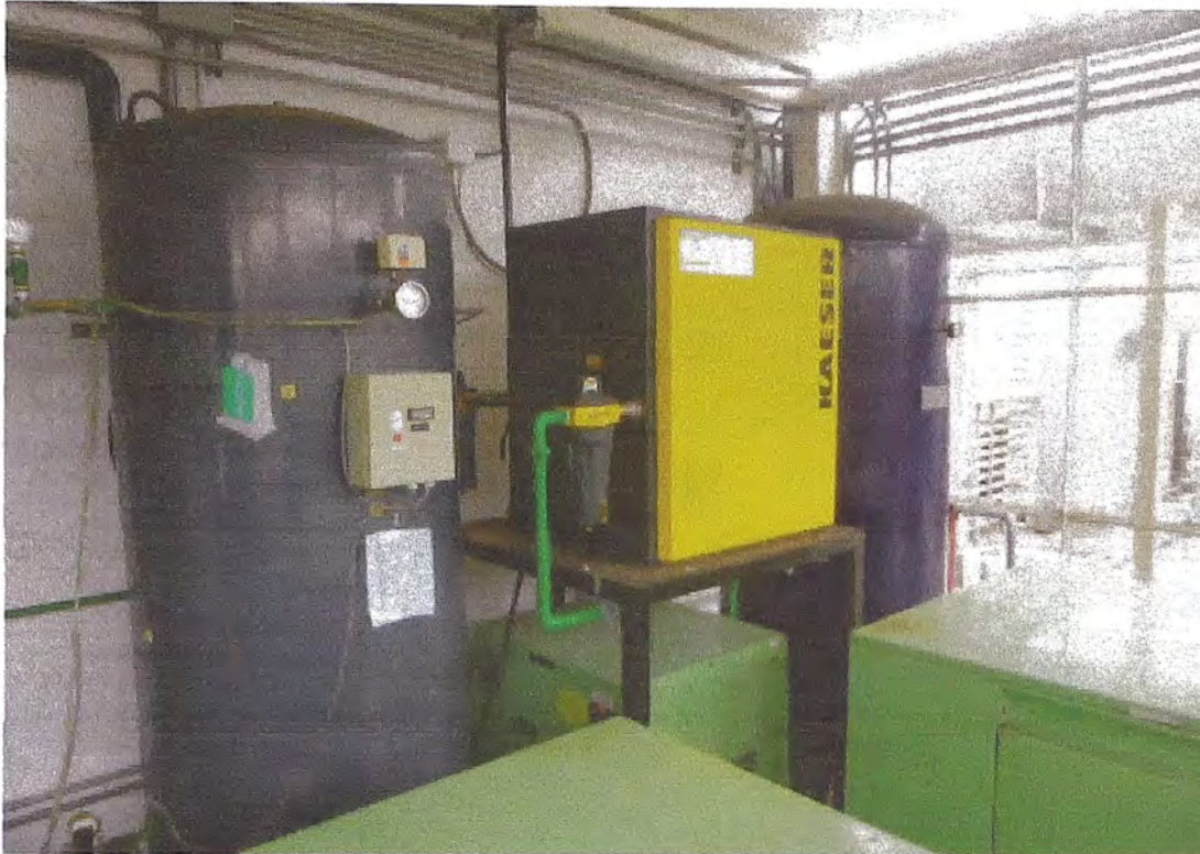
Figura 6.4. Secador de aire y tanque de aire
