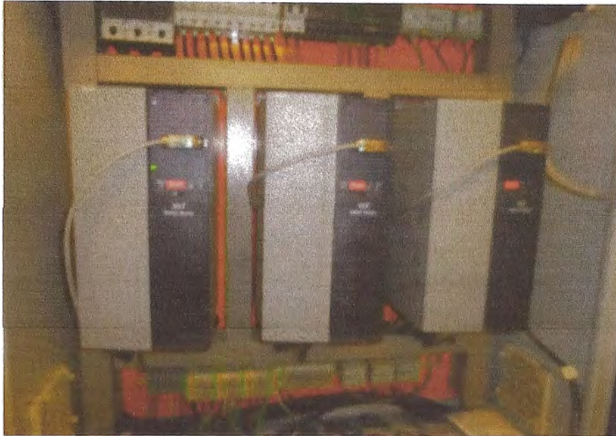
Figura 6.14. Variadores de Tablero de Sistema de Bombeo de agua dura
