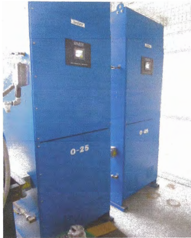
Figura 6.2. Generadores de oxígeno nuevos
