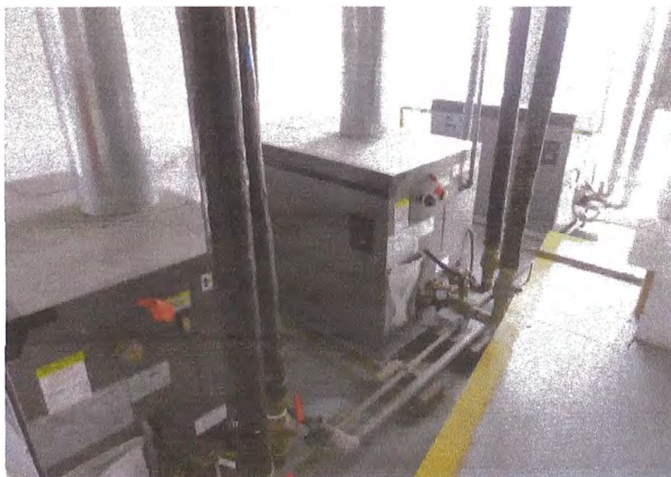
Figura 6.15. Sala de Calentadores de agua
