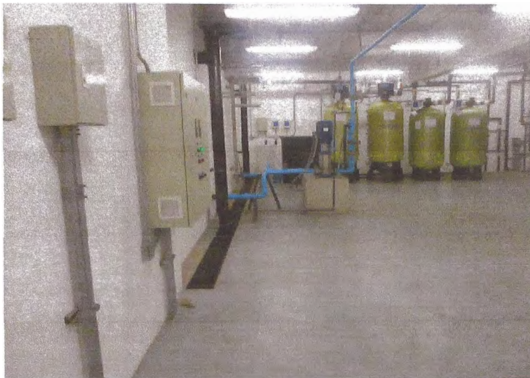
Figura 6.5. Planta de Tratamiento de Agua
