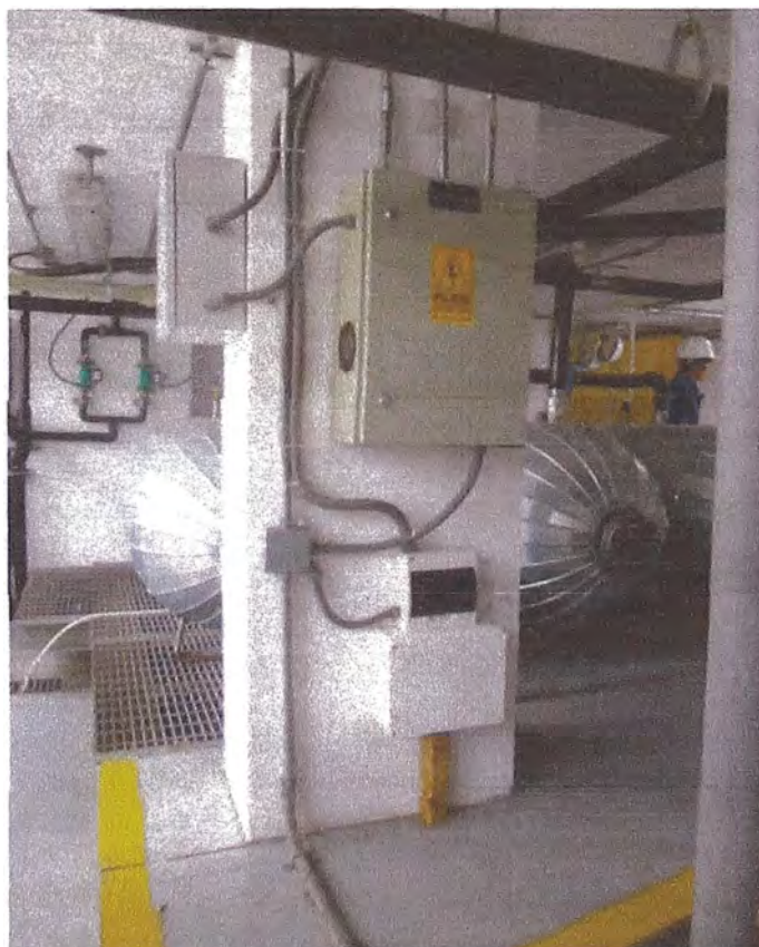
Figura 6.17. Tablero eléctrico de sala de calentadores de agua
