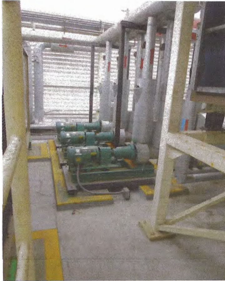
Figura 6.19. Bombas del sistema de climatización
