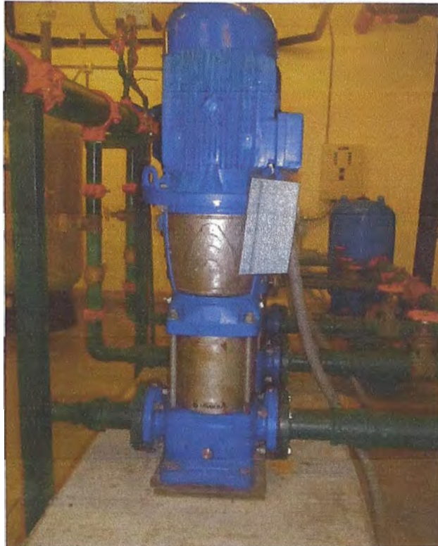
Figura 6.12. Bomba de Agua Dura
