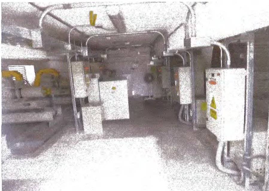
Figura 6.27. Sala eléctrica de Ascensores
