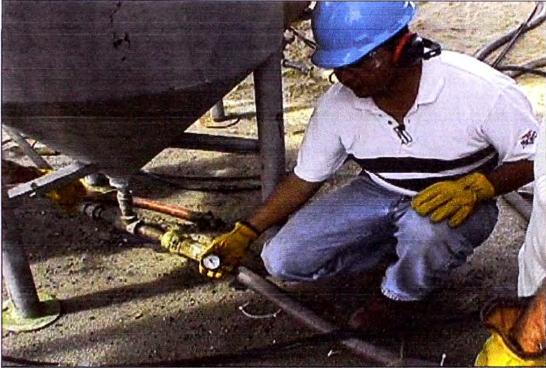
Fig. 4.10 Medición de presión a la salida de la tolva de abrasivo
