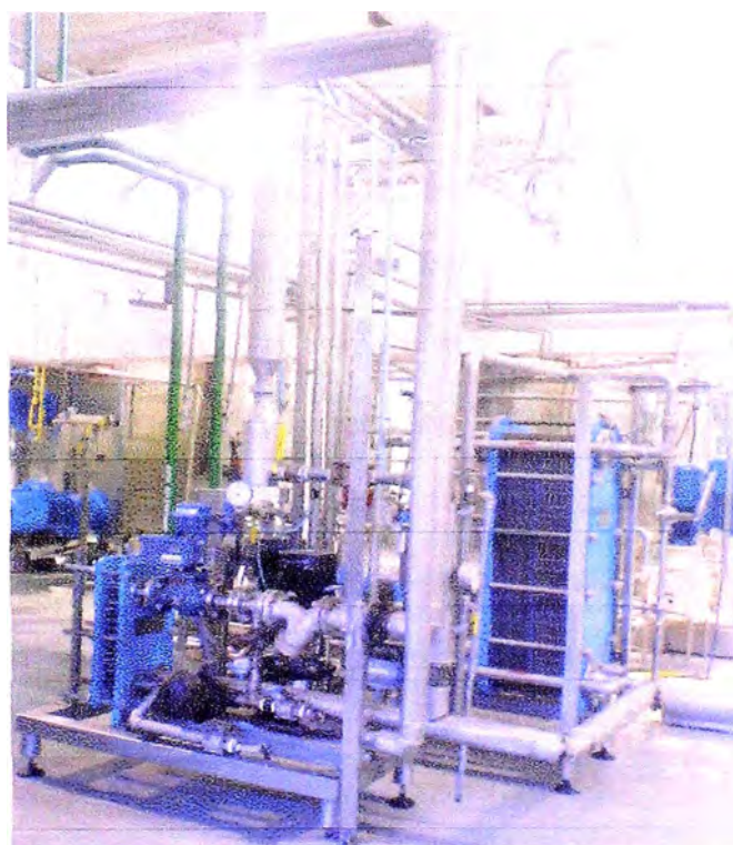
Fig. 2.13 Intercambiador de Calor
