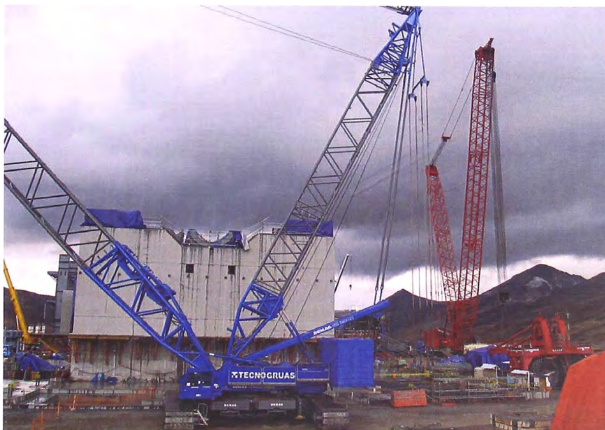
Foto 5.6.- Grúa 600 t Demac Manitowock (color azul) y Grúa 800 t Manitowock con Maxel (color rojo).
