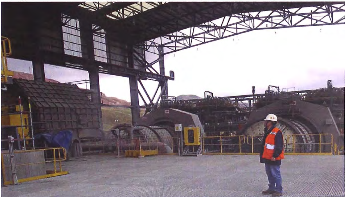
Foto 4.5.- Interior de edificio de molinos, plataforma de operación.
