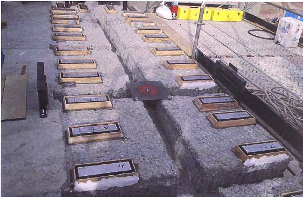
Foto 5.8.- Ubicación de laines sobre el concreto y quedarán bajo de sole plates de las chumaceras, espacio que se llenará con grout.
