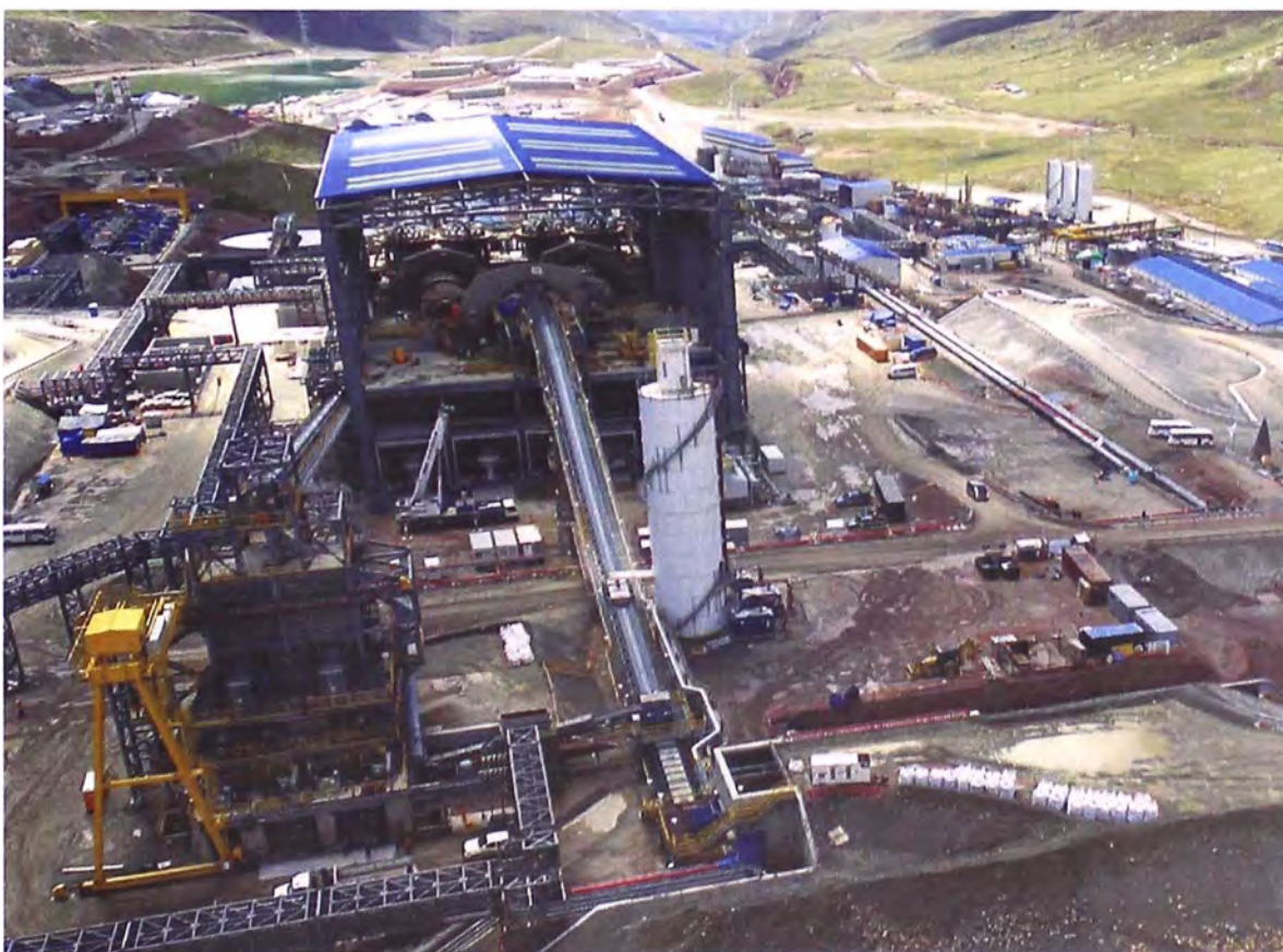
Foto 4.3.- Vista panorámica del área de molienda. Se muestra faja alimentación al molino Sag, edificio de molienda y chancadores de pebbles (lado izquierdo).
