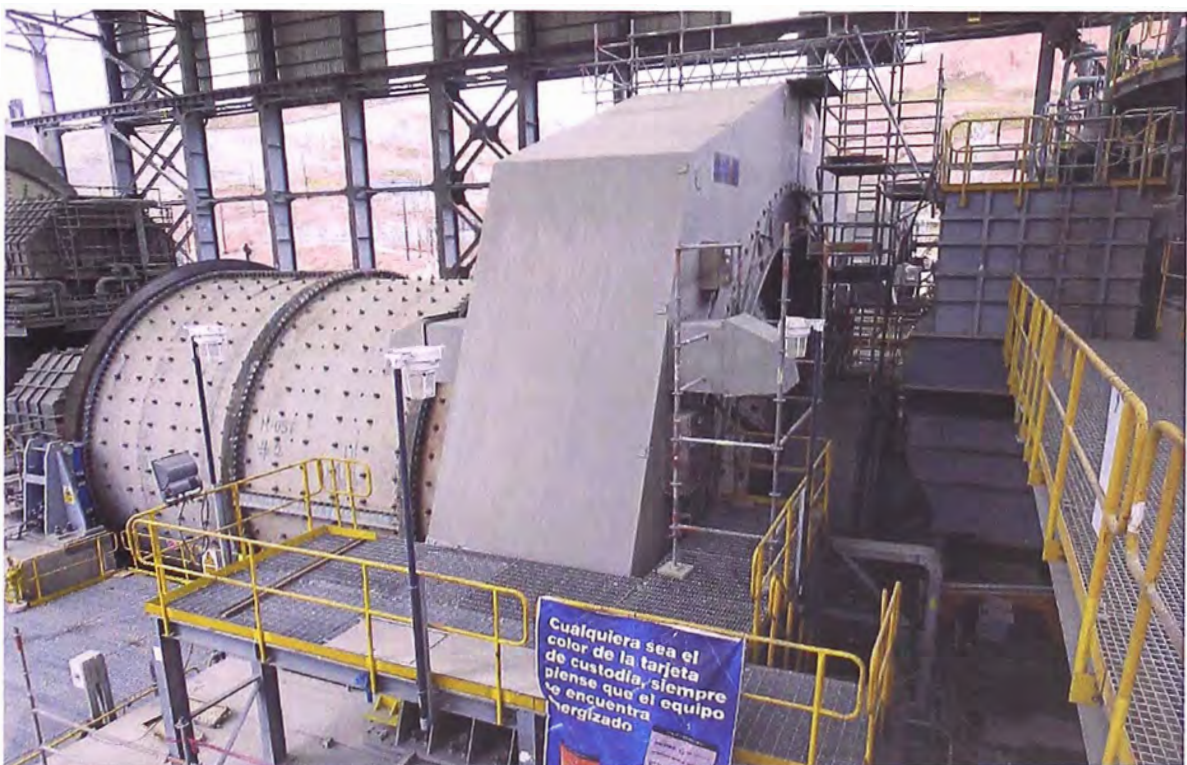
Foto 5.22.- Se muestra zona de alimentación Molino de Bolas.
