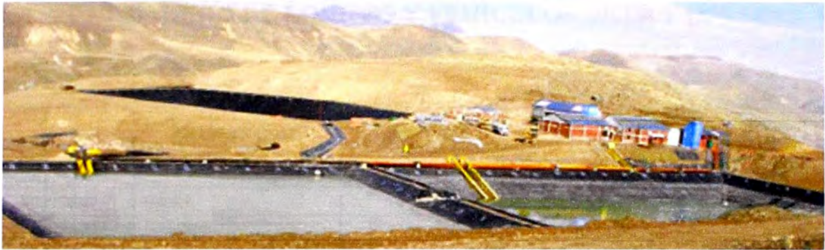
Fotografía N° 1.6 Pozas de colección del mineral luego de su tratamiento en el pad
