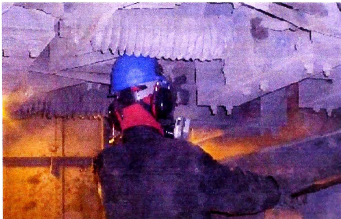
Figura 3.3 Activación manual de las compuertas de las tolvas
