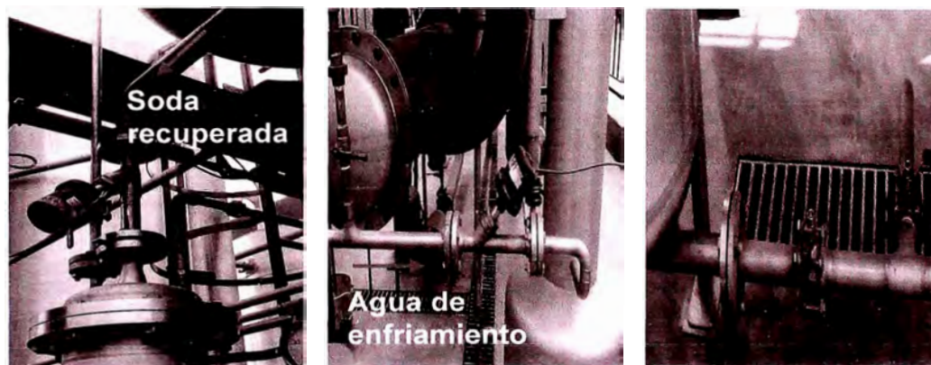
Figura N° 4.36 – Enfriador de soda cáustica
