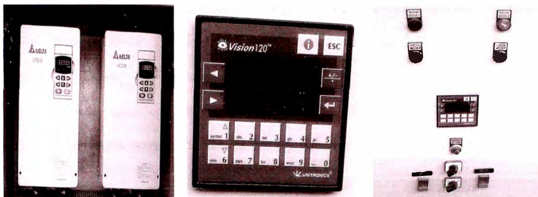
Figura N° 4.46 – Tablero para control de electrobombas
