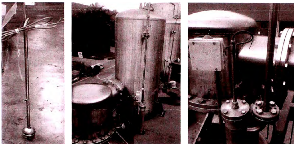
Figura N° 4.28 – Transmisor de nivel en separador
