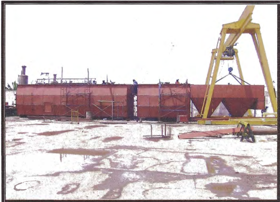
Figura 4.22, Celda de tratamiento ensamblada por completo
