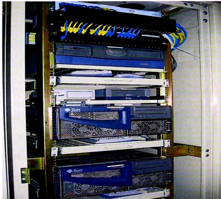
Figura 3–3 Rack de Servidores del SCADA
