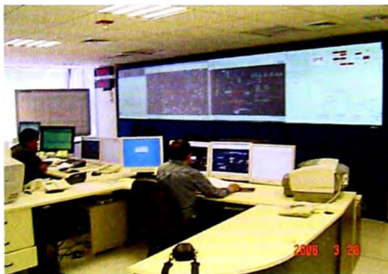
Figura 2-1 Centro de Control de REP
