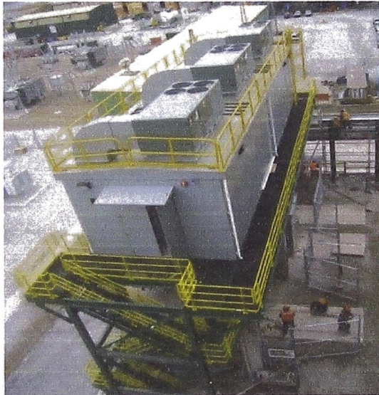
Figura 2.4 SALA ELECTRICA DEL PROYECTO
