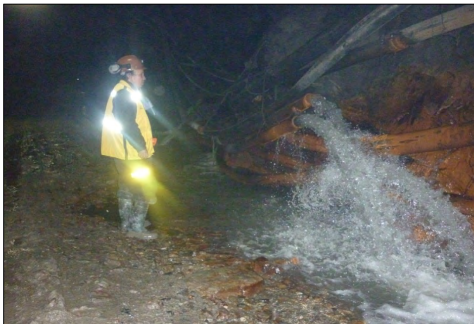
Figura 3.4: Bombeo de agua en Niveles de profundización 1020,1070 y 1120
