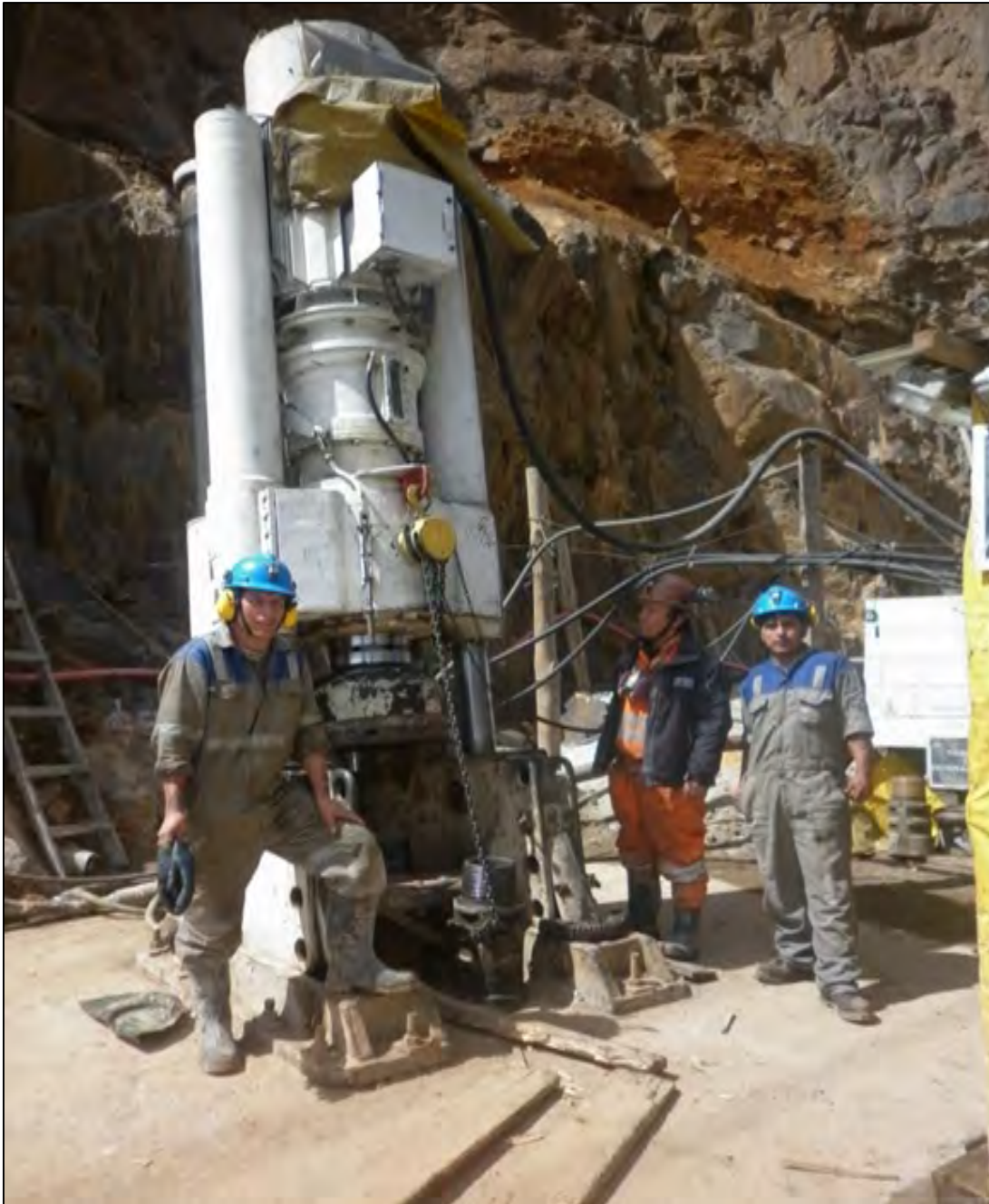
Figura 3.3: Equipo Raice Borer de Master Drilling (Cabeza instalado en superficie mina San Cristóbal)
