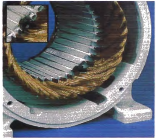
6 – Falla a tierra en el Borde de una Ranura
