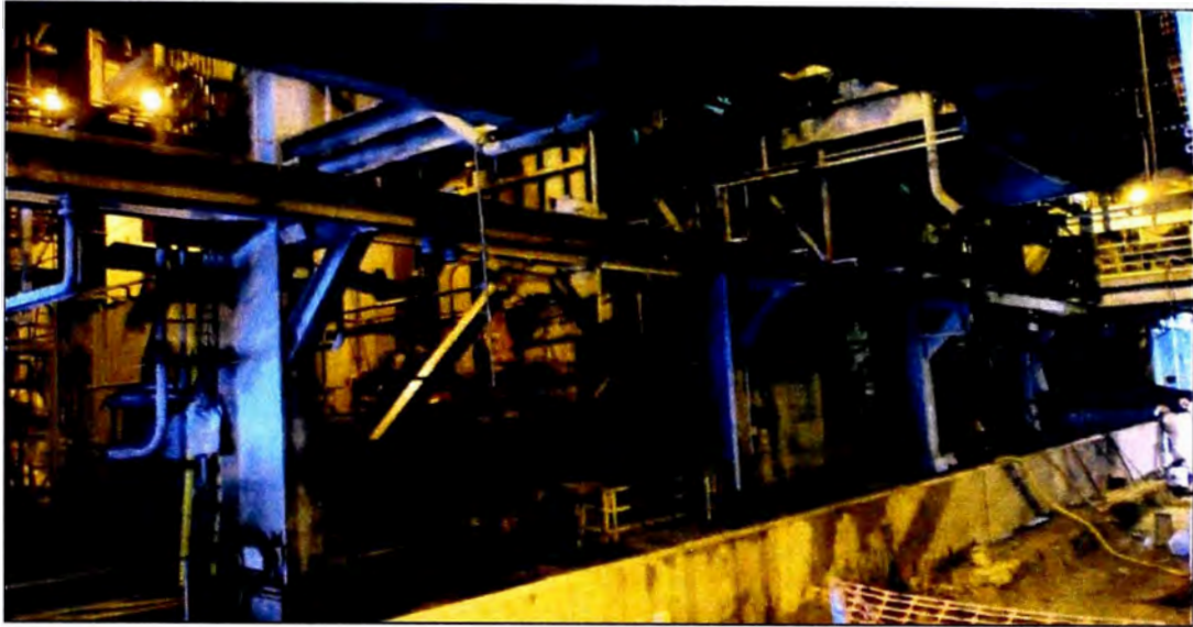
Ilustración 3.13: Viga monorriel sobre el Trench
