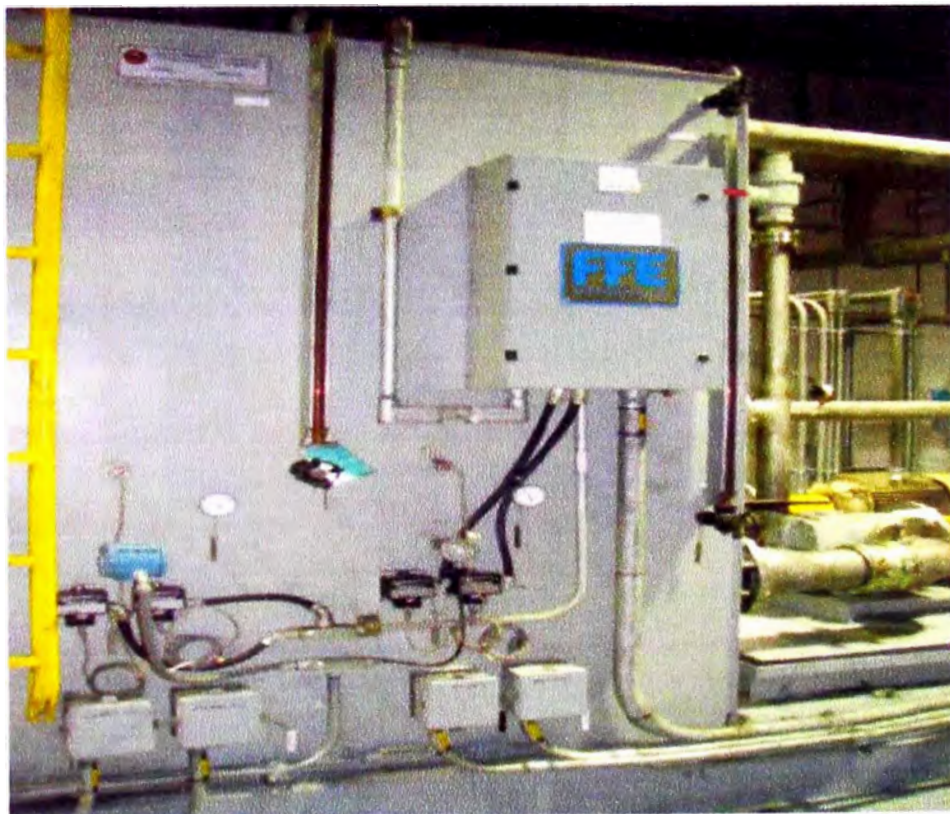
SENSORES DE TEMPERATURA DEL DEPOSITO
