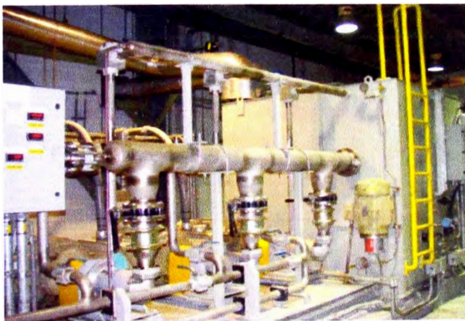
TUBERIAS. VALVULAS DE ALIVIO Y BOMBA DE CARGA
