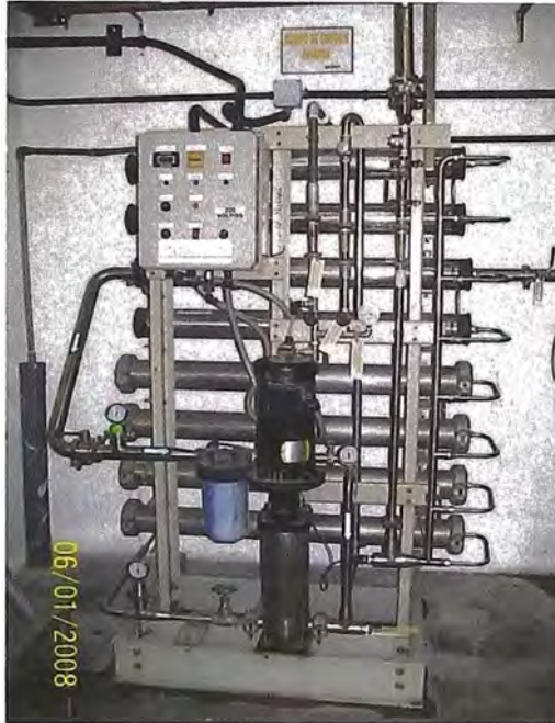
Gráfico 2.6.1.1 Sistema de osmosis inverso de 20gpm
