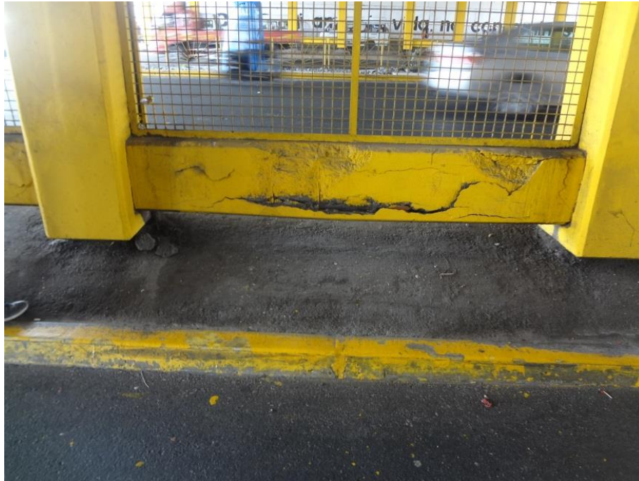
Foto 9. Se observa pérdidas de sección críticas en la viga de conexión entre pilares
