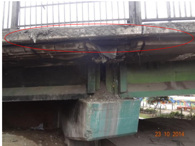
Deterioro del concreto en losa y vigas por falta de mantenimiento (Olarte et al., 2015)
