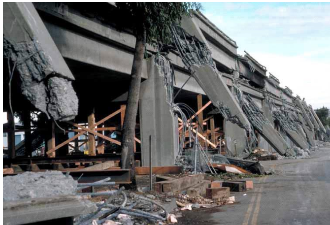
Figura 8. Falla en los nodos Fuente: Landa et al. , (2006)
