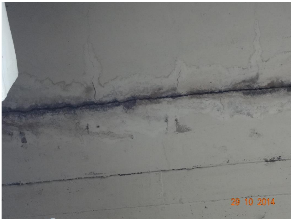
Figura 38. Vista cercana de eflorescencia en la cara inferior del tablero debido a la infiltración de agua por la junta. Fuente: Elaboración Propia
