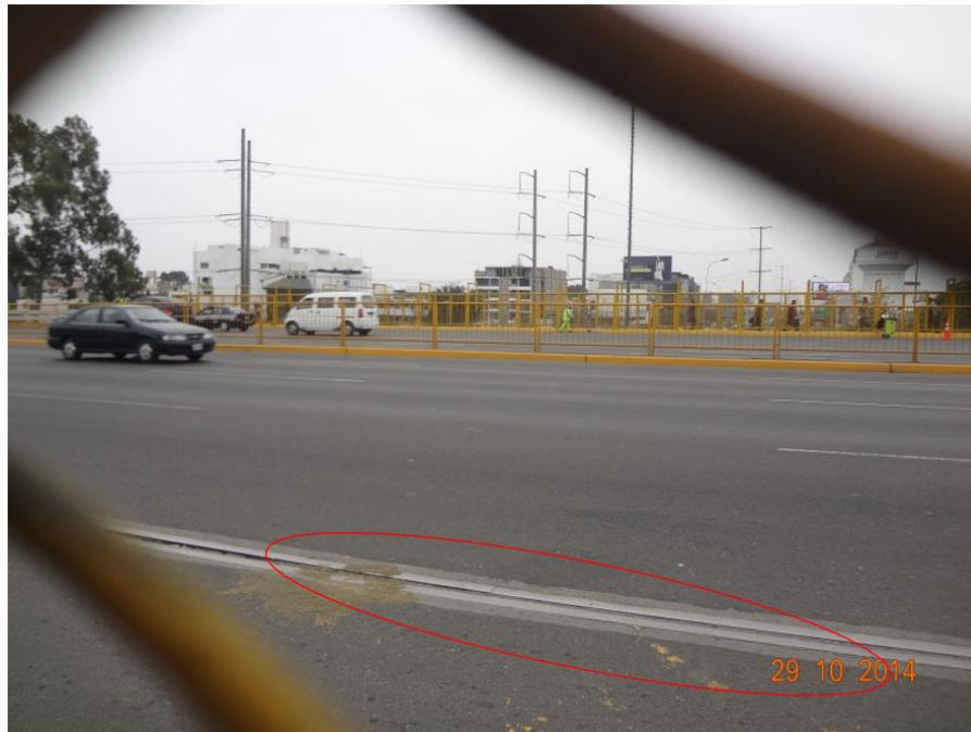
Foto 11. Junta de dilatación que separan al puente primavera original con la nueva extensión realizada.
