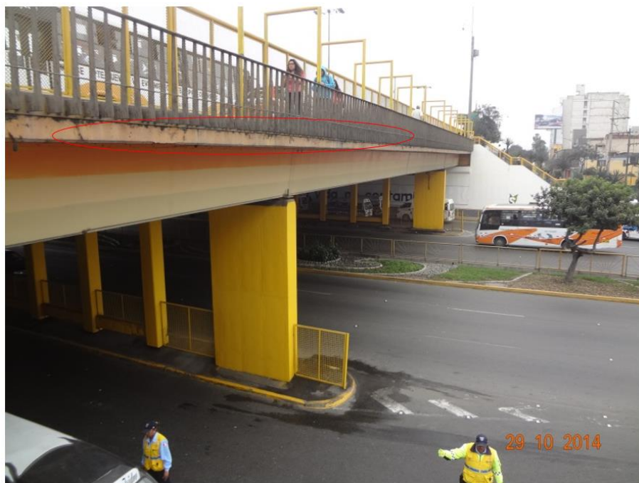
Foto 14. Fisuras en el tablero del puente.
