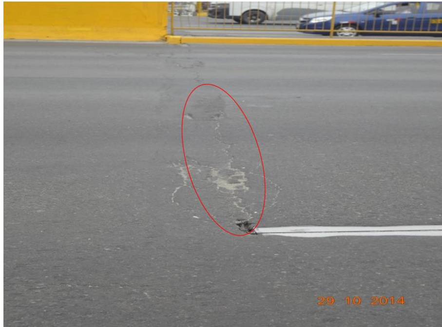
Foto 13. Toma cercana de fisuras en la junta del tablero.
