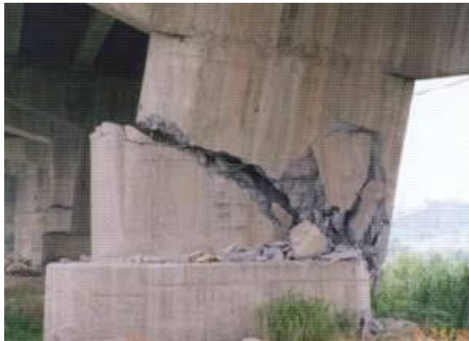
Figura 7. Falla por cortante en columna de un puente ocurrida en Taiwán en el sismo de 1999 Fuente: Landa et al. , (2006)
