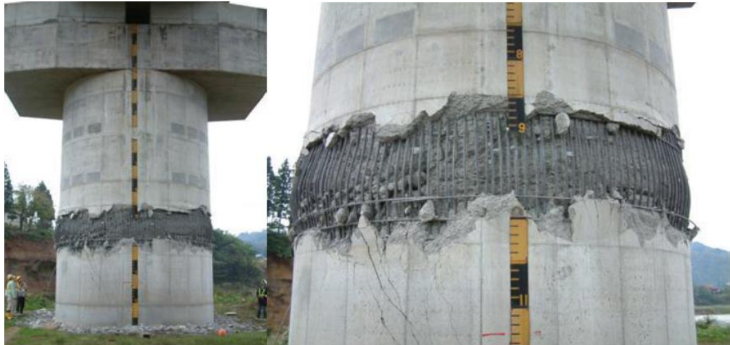
Figura 6. Pérdida de recubrimiento y pandeo de las varillas longitudinales Fuente: Landa et al. , (2006)
