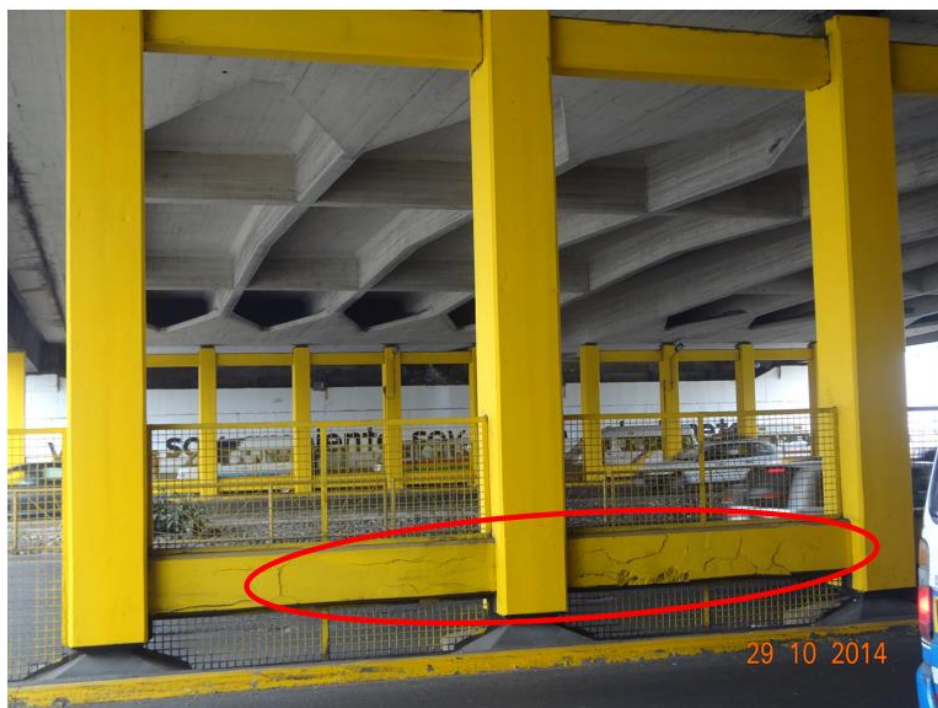
Figura 40. Grietas y desprendimiento en las vigas inferiores debido al poco refuerzo transversal y el deficiente recubrimiento. Fuente: Elaboración Propia
