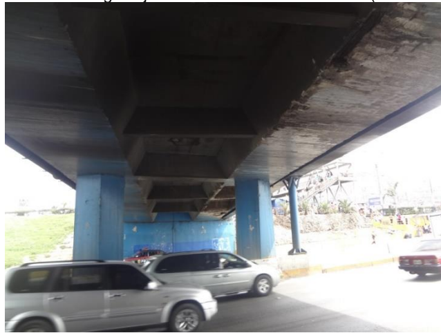
Desprendimiento en otra viga cajón debido a colisión vehicular (Olarte et al., 2015)
