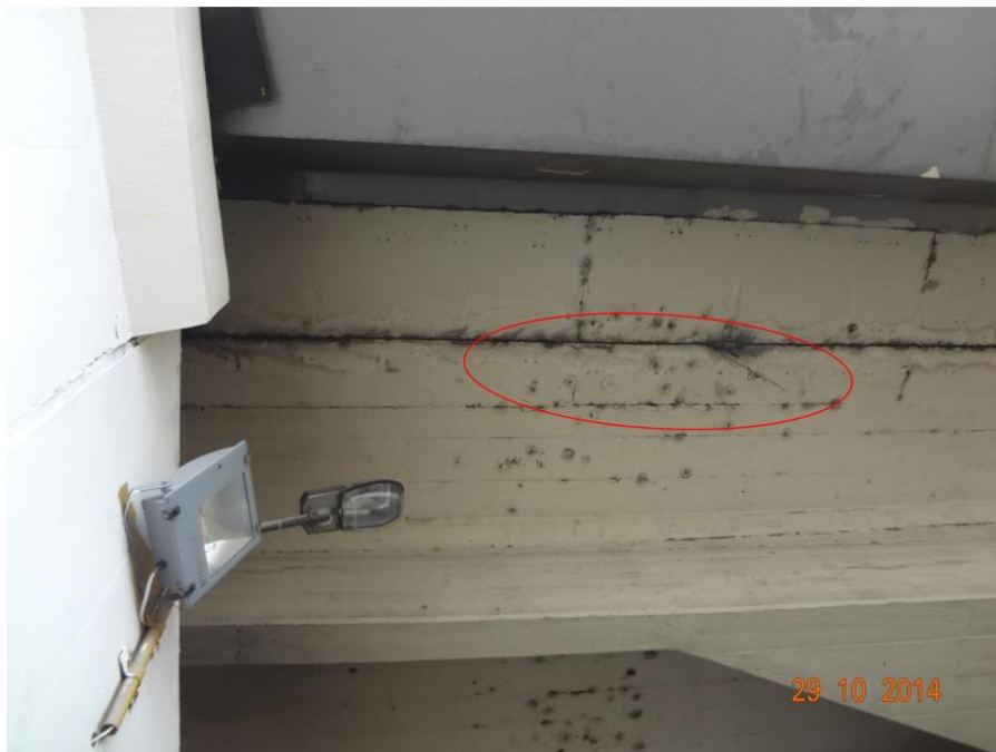
Foto 3. Fisuras en la cara inferior de la losa
