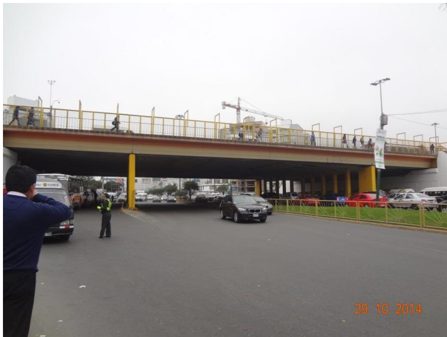
Foto 2. Vista longitudinal del Puente Primavera, el cual pertenece al Intercambio Vial Sur.
