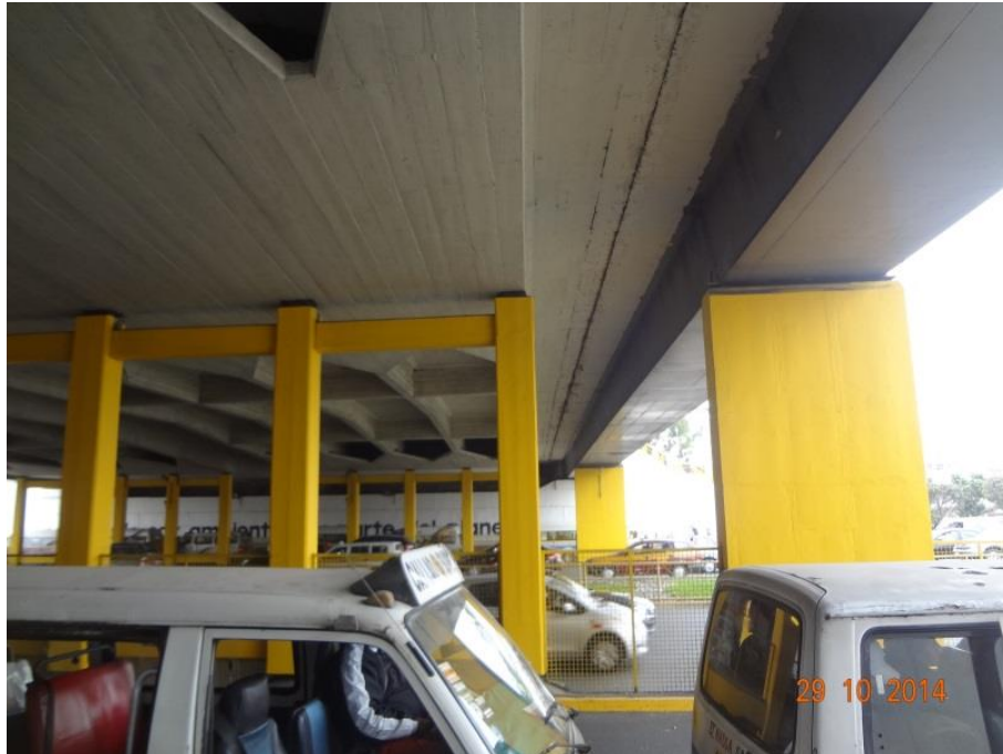
Foto 5. Se observan dos apoyos de 05 columnas cada uno y 01 placa que soporta la vereda.
