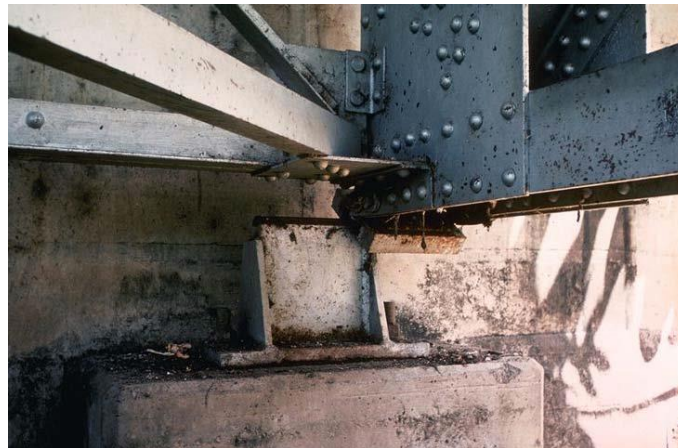
Figura 9. Falla en elementos de acero Fuente: Landa et al. , (2006)
