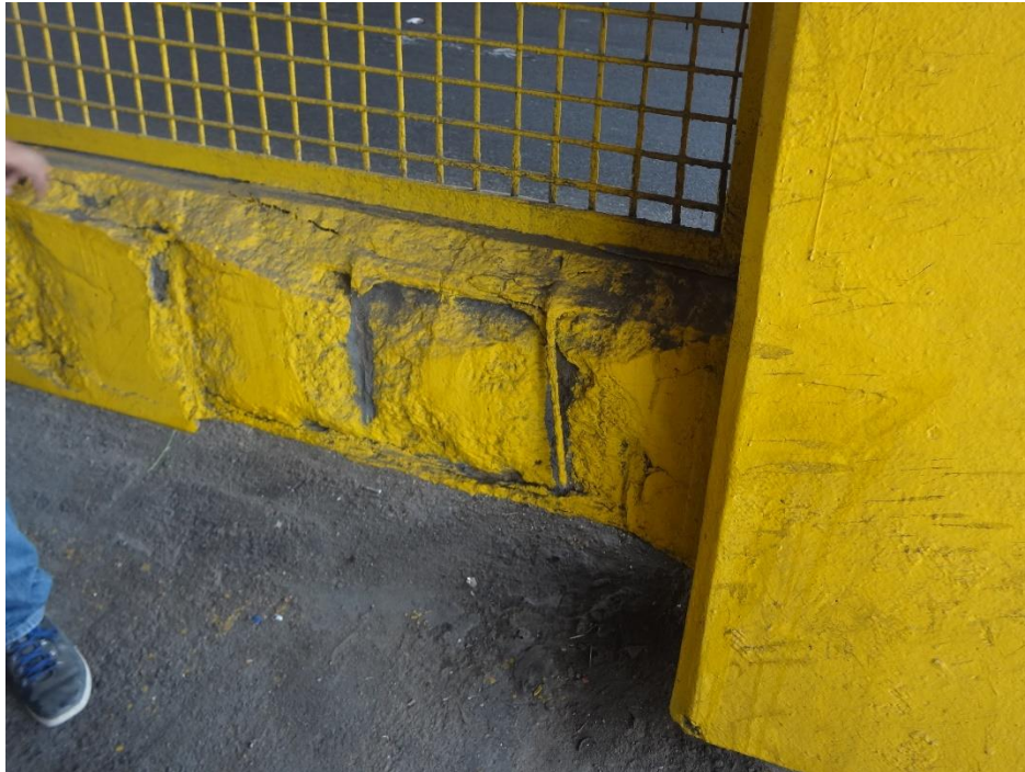
Figura 41. Desprendimiento y acero expuesto en las vigas inferiores debido al poco refuerzo transversal y el deficiente recubrimiento. Fuente: Elaboración Propia
