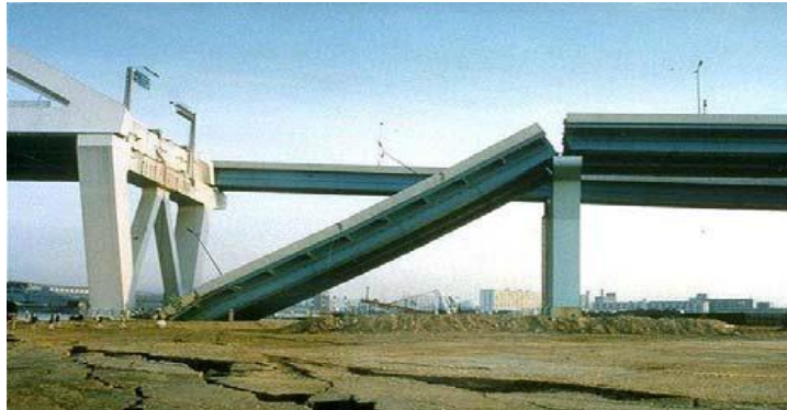
Figura 1. Falla ocasionada por desplazamientos longitudinales excesivos Fuente: Landa et al. , (2006)
