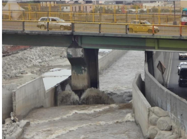
Posible socavación en el pilar del puente Ricardo Palma (Olarte et al., 2015)
