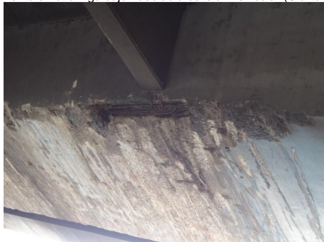
Desprendimiento del recubrimiento y acero expuesto en vigas cajón (Olarte et al., 2015)
