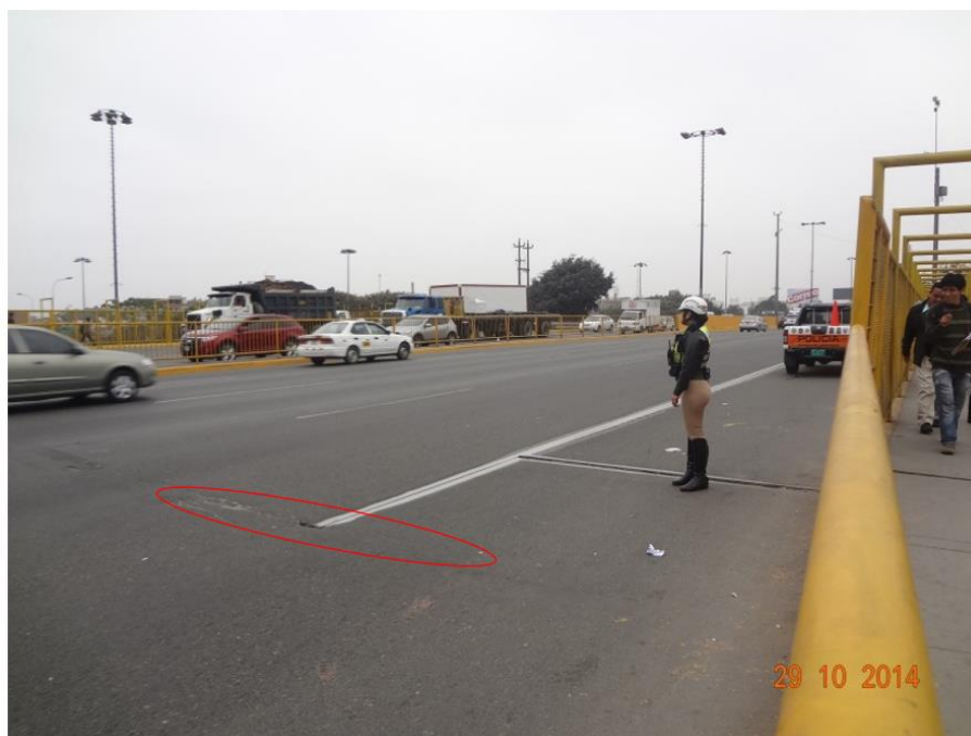
Foto 12. Fisuras transversales en la superficie de rodadura y juntas de tablero.
