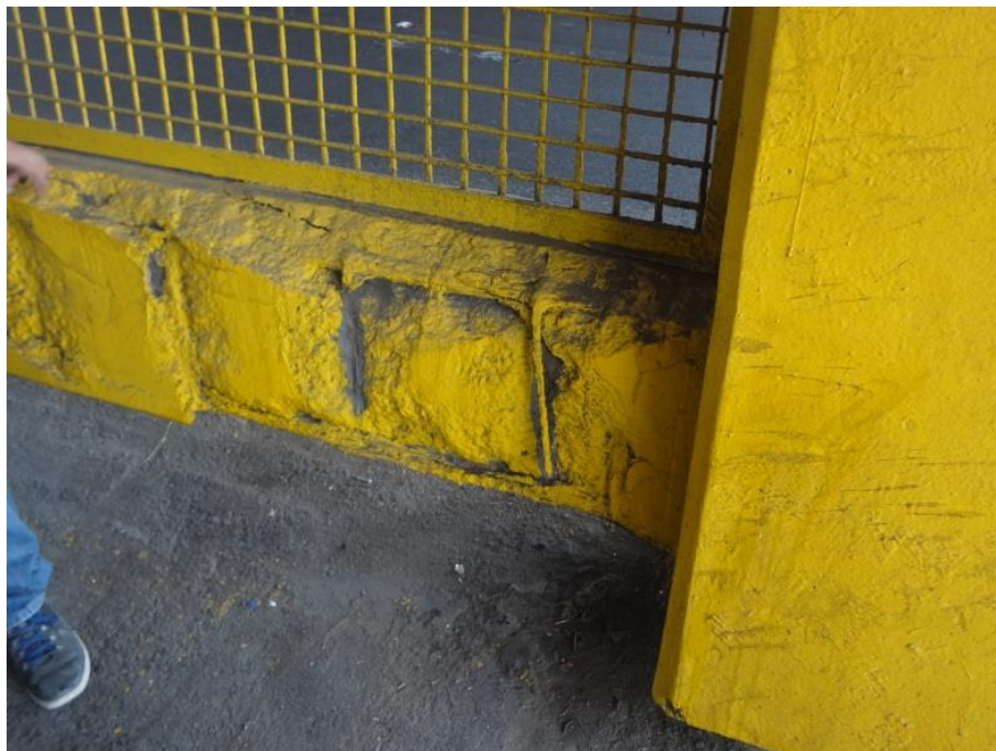
Foto 10. Acero expuesto en la viga de conexión entre pilares
