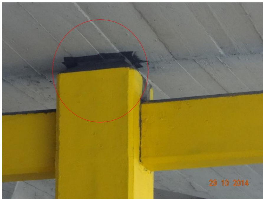
Foto 6. Se observa la articulación entre la columna del pilar y la viga del tablero del puente.
