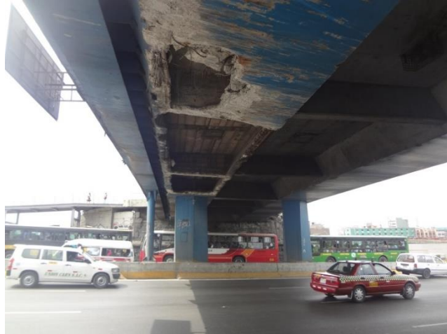
Desprendimiento en viga cajón debido a colisión vehicular (Olarte et al., 2015)
