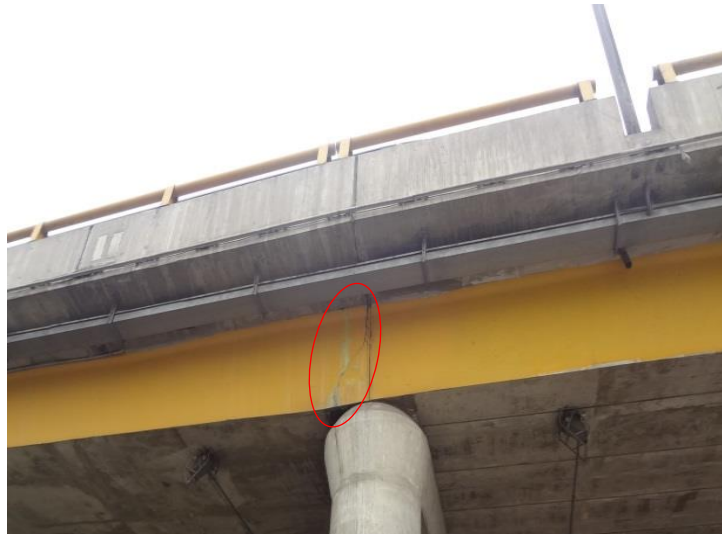
Se observa fisuras en el apoyo de la losa sobre el pilar en la cara externa del puente (Olarte et al., 2015)
