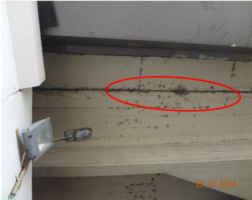
Figura 37. Presencia de eflorescencia y pequeñas fisuras en la cara inferior del tablero debido a la infiltración de agua por la junta. Fuente: Elaboración Propia.
