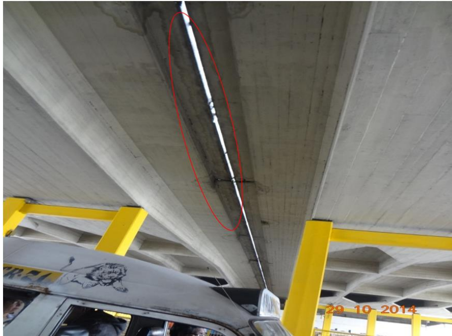
Foto 7. Se observa una separación mínima de las carpetas de rodadura.
