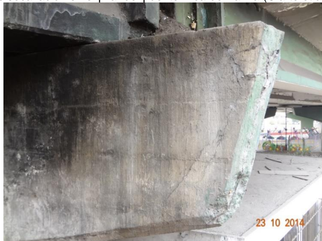
Fisuras, grietas y pérdida de sección (acero expuesto) en el alero del pilar (Olarte et al., 2015)
