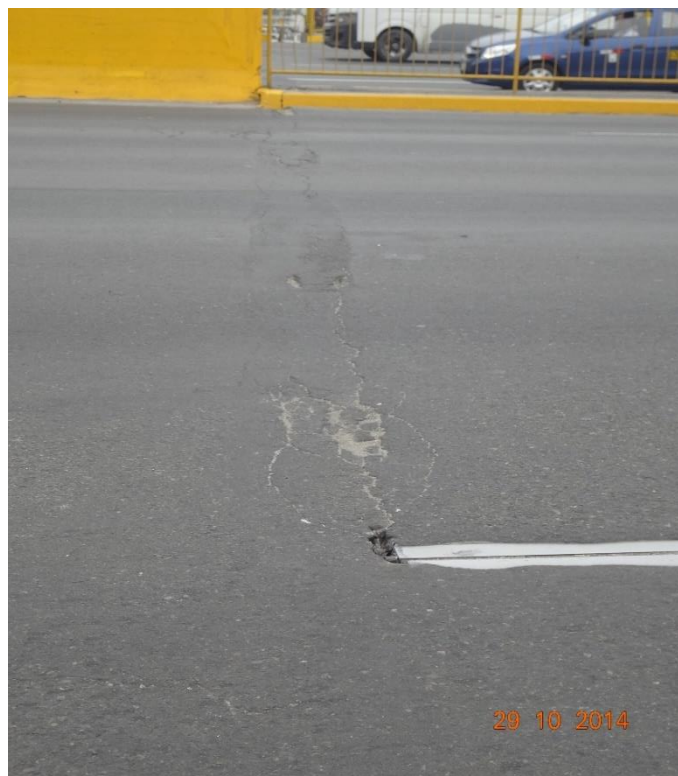
Figura 42. Fisuras en la carpeta asfáltica y juntas de expansión debido a un inadecuado sello de la junta y que la junta no tenga la capacidad suficiente de absorber las deformaciones. Fuente: Elaboración Propia
