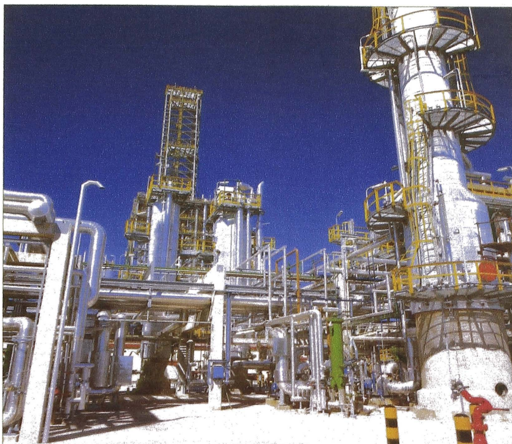
Fig.2.25 Unidad de coquización
