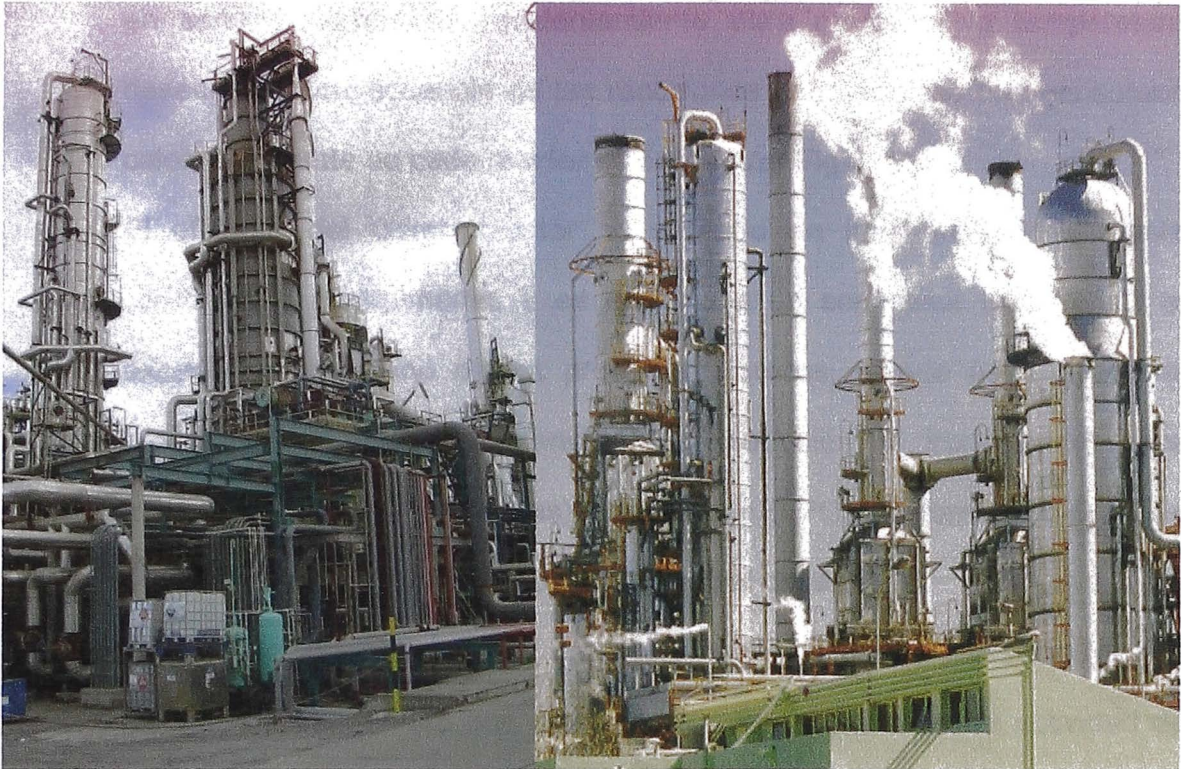
Fig.2.15. Unidades de destilación atmosférica y a vacío
