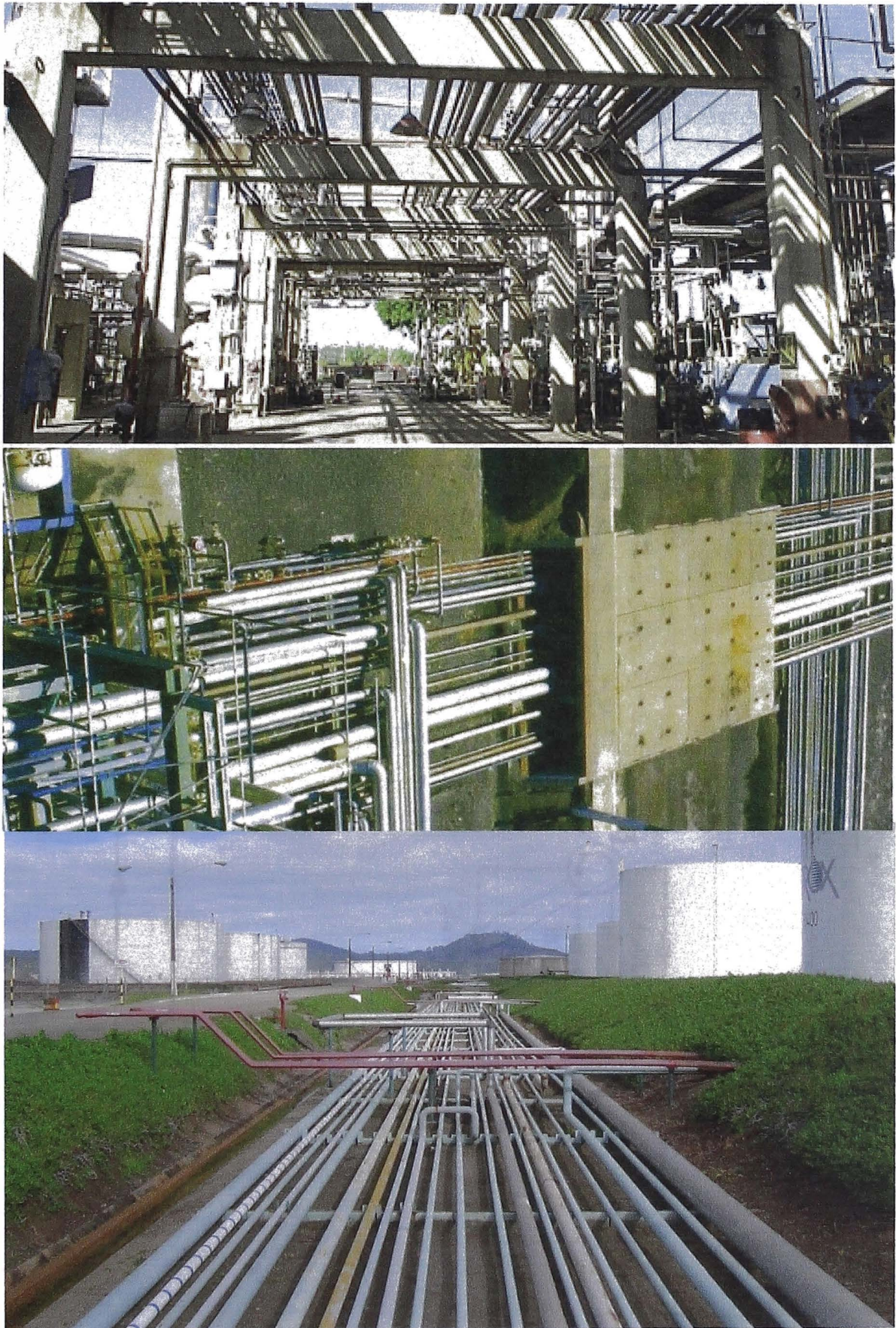
Fig.2.34. Racks de tuberías en una refinoría de petróleo.
