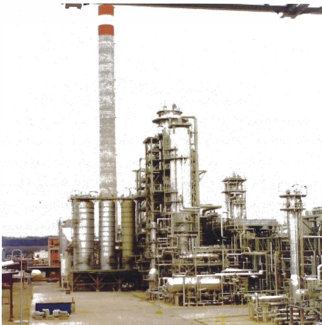
Fig.2.20. Unidad de cracking catalítico.
