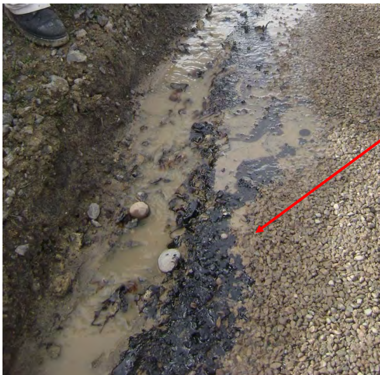
Trabajos de Mantenimiento Especializado (véase derrame de asfalto líquido en sistema de drenaje que va a los cursos de agua)
