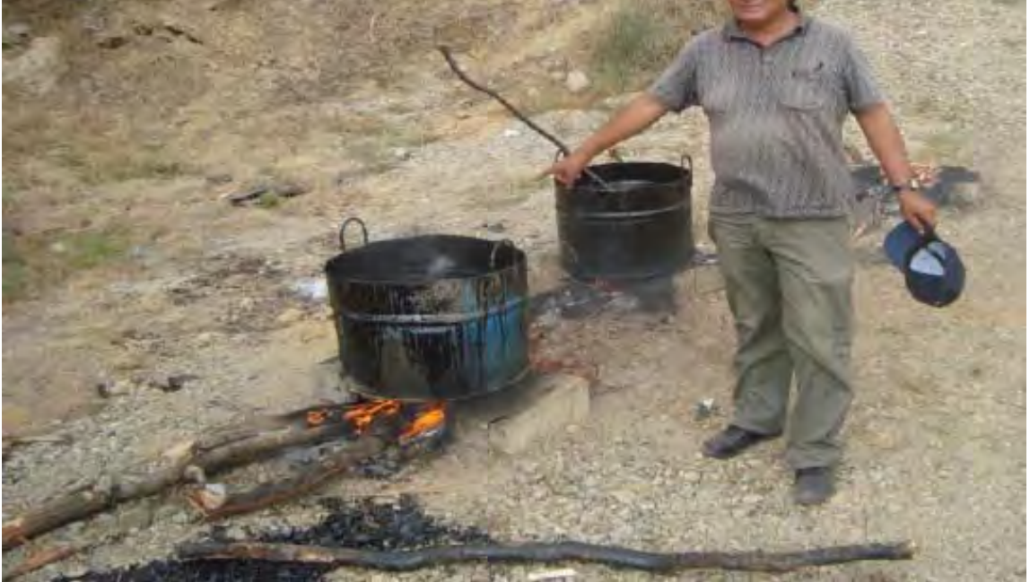
Quema de leña para calentar asfalto líquido (véase la falta de protección)
