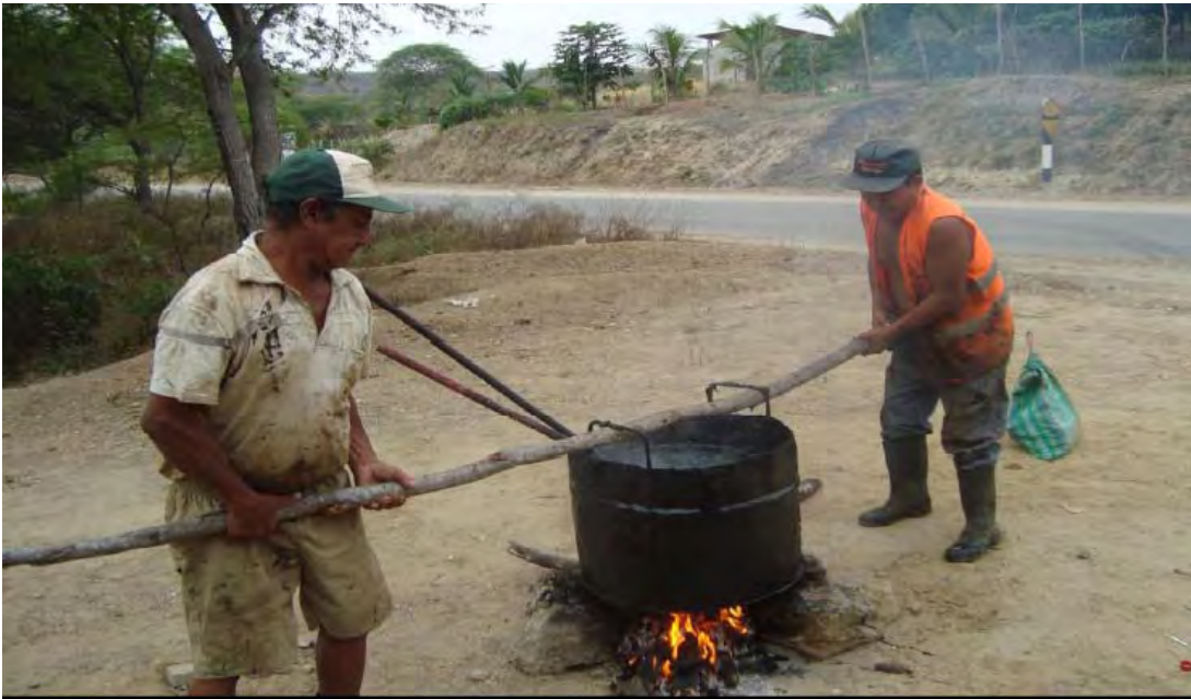
Manipuleo del asfalto caliente (véase la falta de protección)
