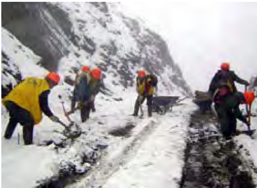
Personal de mantenimiento eliminando nevadas sin protección
