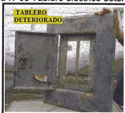
Figura N°08 Tablero eléctrico deteriorado
