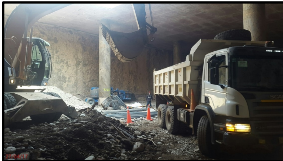
Figura N°3.45: Excavación por debajo de la losa superior, se aprecia los pilotes Fuente: Internet, obra de la Línea 2 del Metro de Lima
