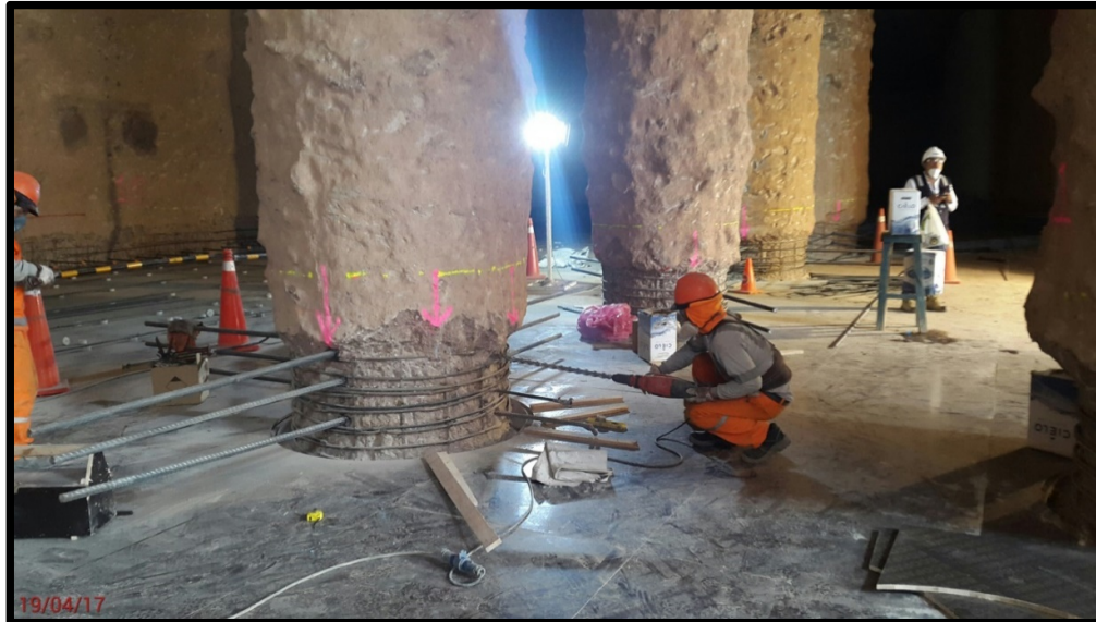
Figura N°3.48: Colocación de anclajes en pilote en el empotramiento con la losa intermedia
