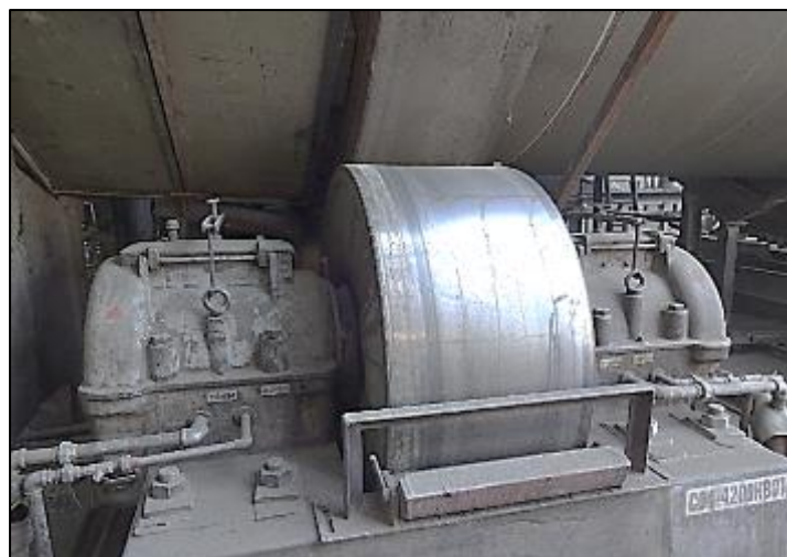
Figura 4.41 Polín de rodadura y soporte rígido con bancada rotulada.
