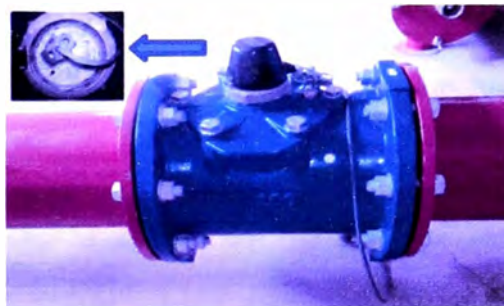
Figura 4.13. Caudalímetro. Fuente: Foto tomada el 10/09/2011
