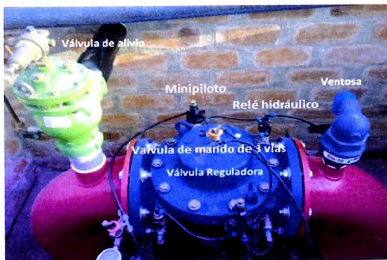
Figura 4.5. Válvula reguladora, con todos sus componentes de apoyo. Fuente: Foto tomada el 10/09/2011
