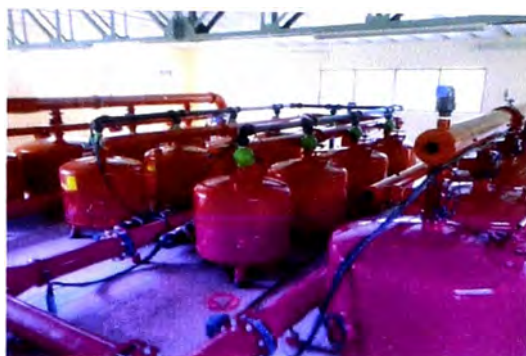
Figura 4.2. Sistema de Filtrado actual. Fuente: Foto tomada el 10/09/2011.
