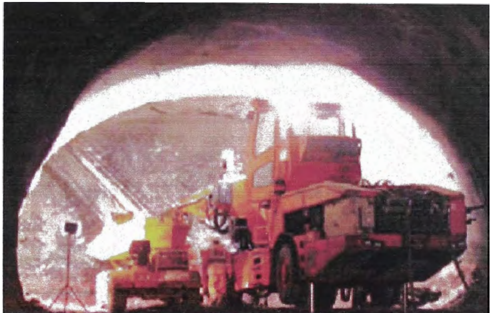
Figura 2.1 Foto de un jumbo en proceso de perforación [11].
