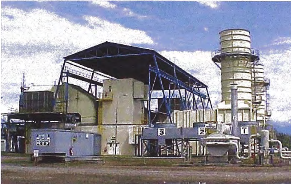
Figura 2.1 Vista General de la Planta Termoelectrica de Aguaytia
