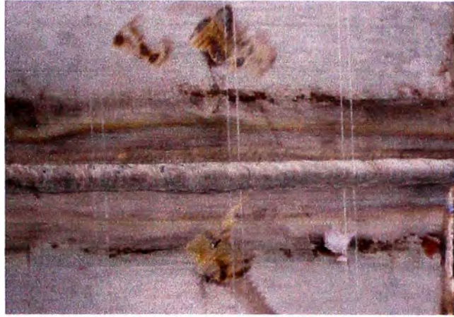
Figura 6.13: Aspecto del Cordón de soldadura en plancha
