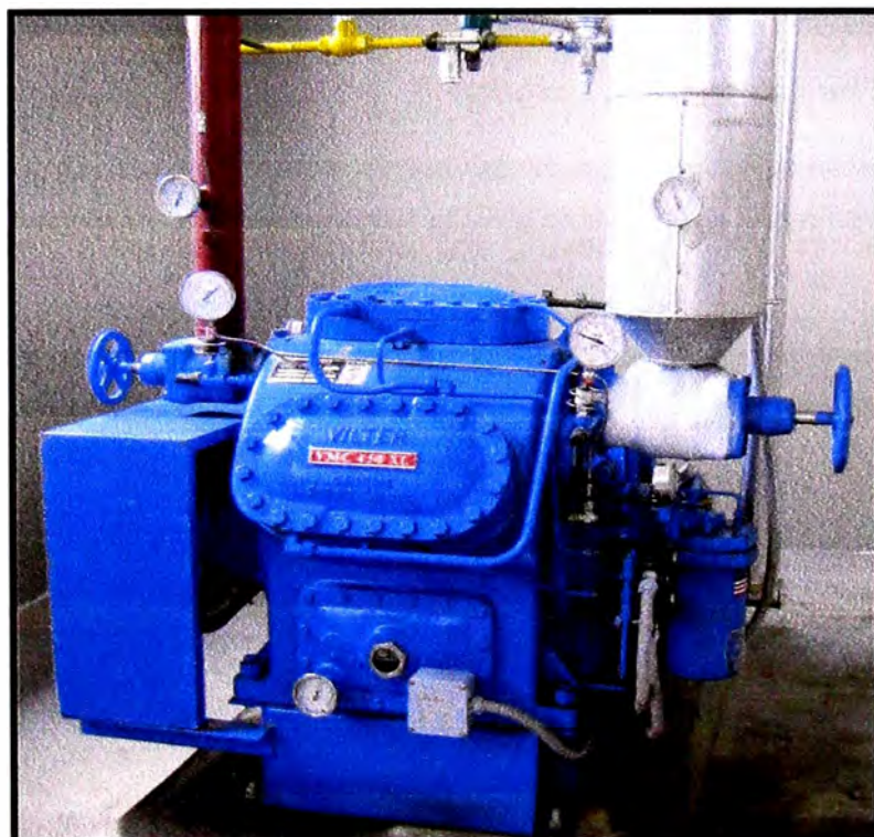
Figura N° 4.5: (Compresor VILTER – sala de maquinas)
