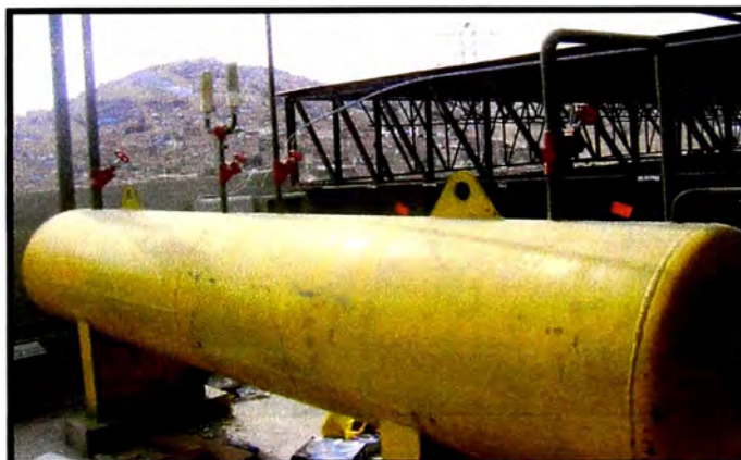
Figura N° 4.13: (Tanque recibidor de liquido TRL)
