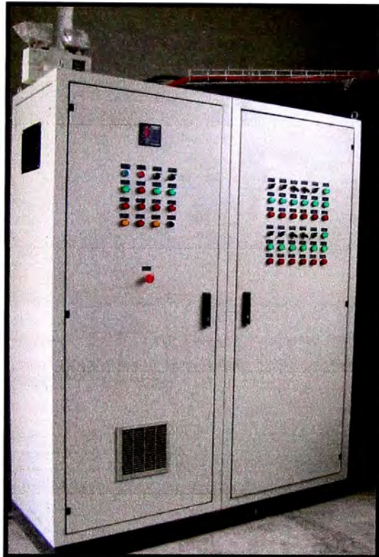
Figura N° 4.17: (Tablero eléctrico de fuerza y control)
