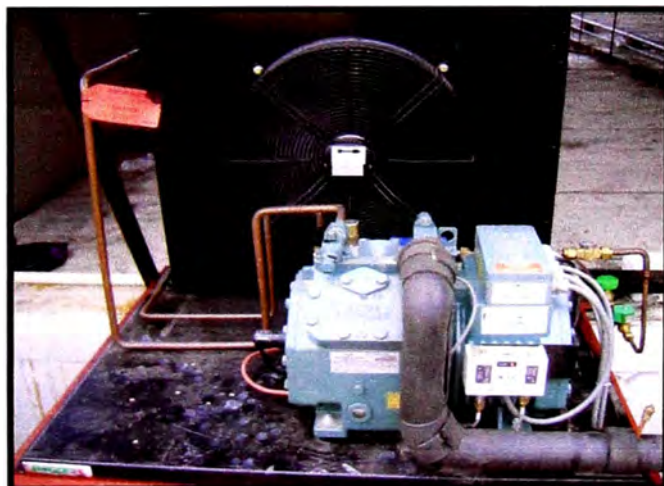
Figura N° 4.25: (Unidad condensadora, silo de hielo)
