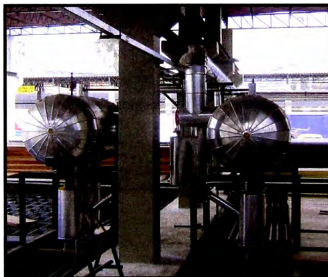
Figura N° 4.12: (TSB conectado a los serpentines evaporadores)
