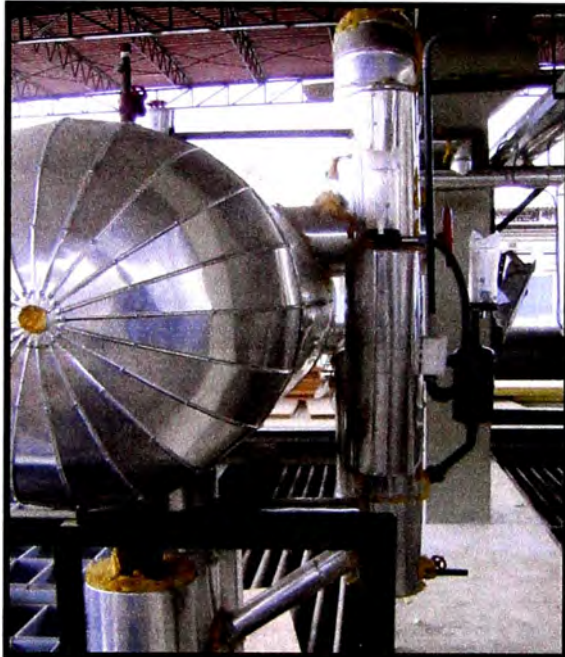
Figura N° 4.10: (Válvulas flotadoras control de nivel de líquido TSB)
