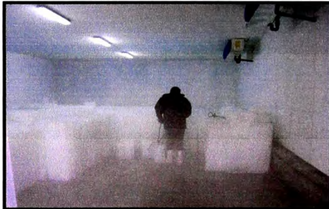
Figura N° 4.24: (Silo de hielo T=-10 °C)
