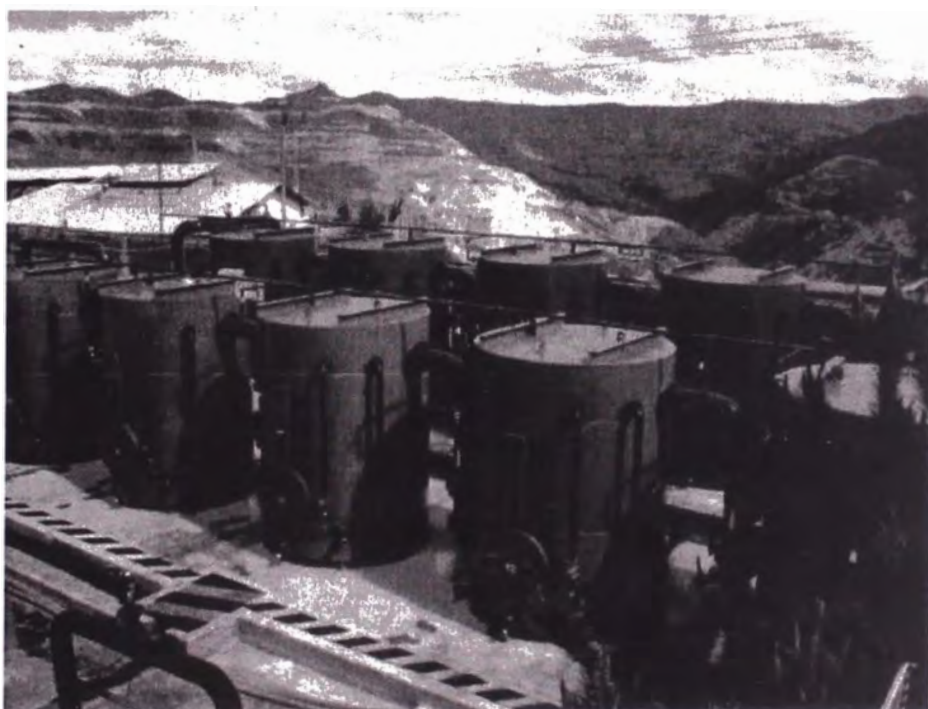
Figura 2.7 Circuito de Adsorción, de 4.0 Ton. de carbón activado por columnas.
