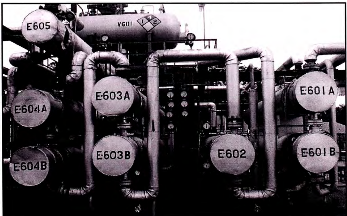
Foto 2.1.9 Vista de Tren de Intercambiadores
