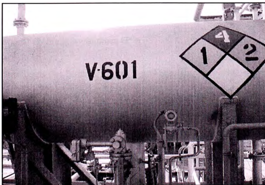
Foto 2.1.14 Vista Externa de Acumulador de Nafta V-601
