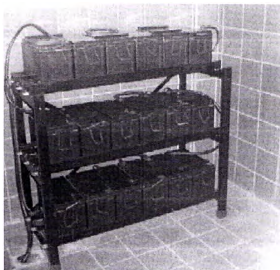
Fig. 4.9: Banco de Baterías
