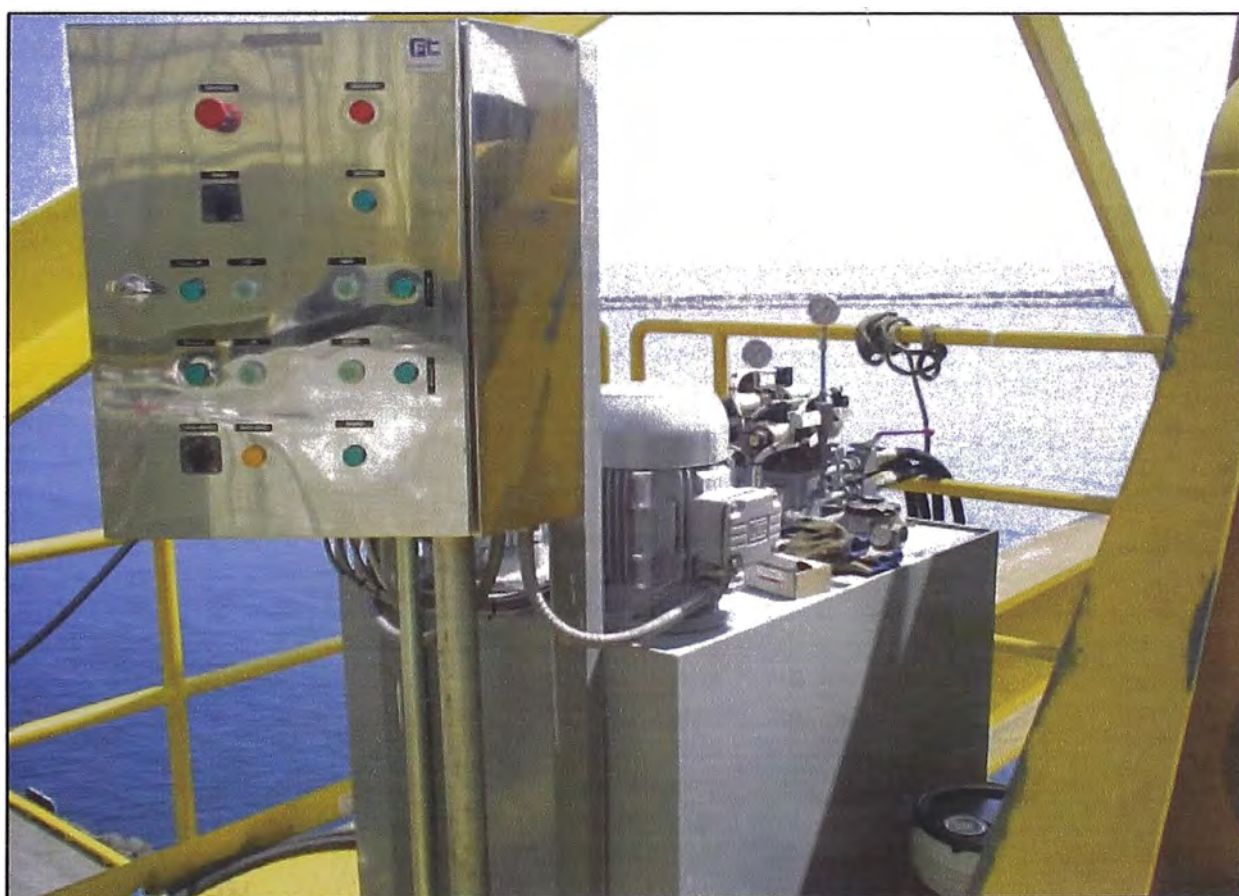
UNIDAD DE PRESION OLEO HIDRAULICA TANQUE 600 LITROS
