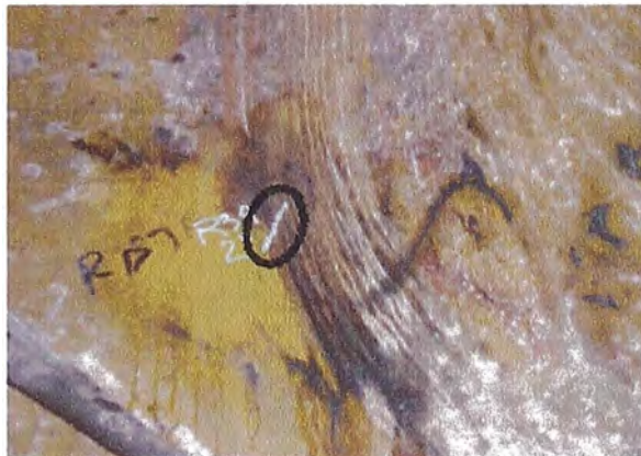
Gráfico 4.4 Rajadura 2 de 2" de longitud
