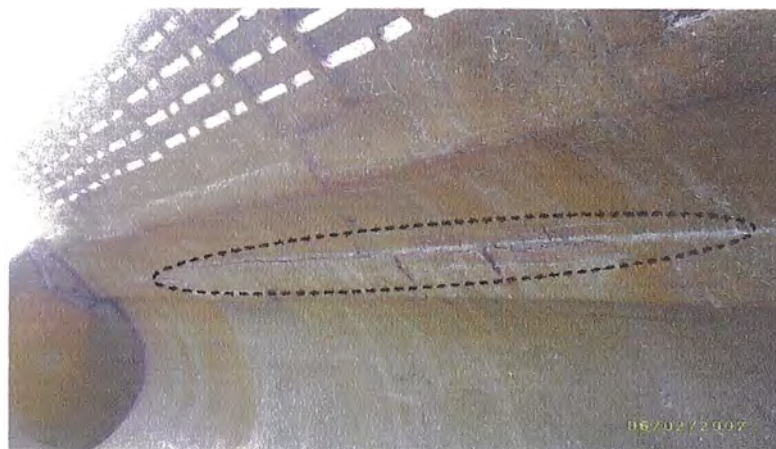
Gráfico 2.18 Rajadura en plancha de refuerzo
