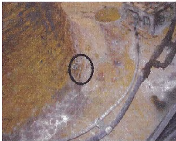
Gráfico 4.3 Rajadura 1 de 6" de longitud
