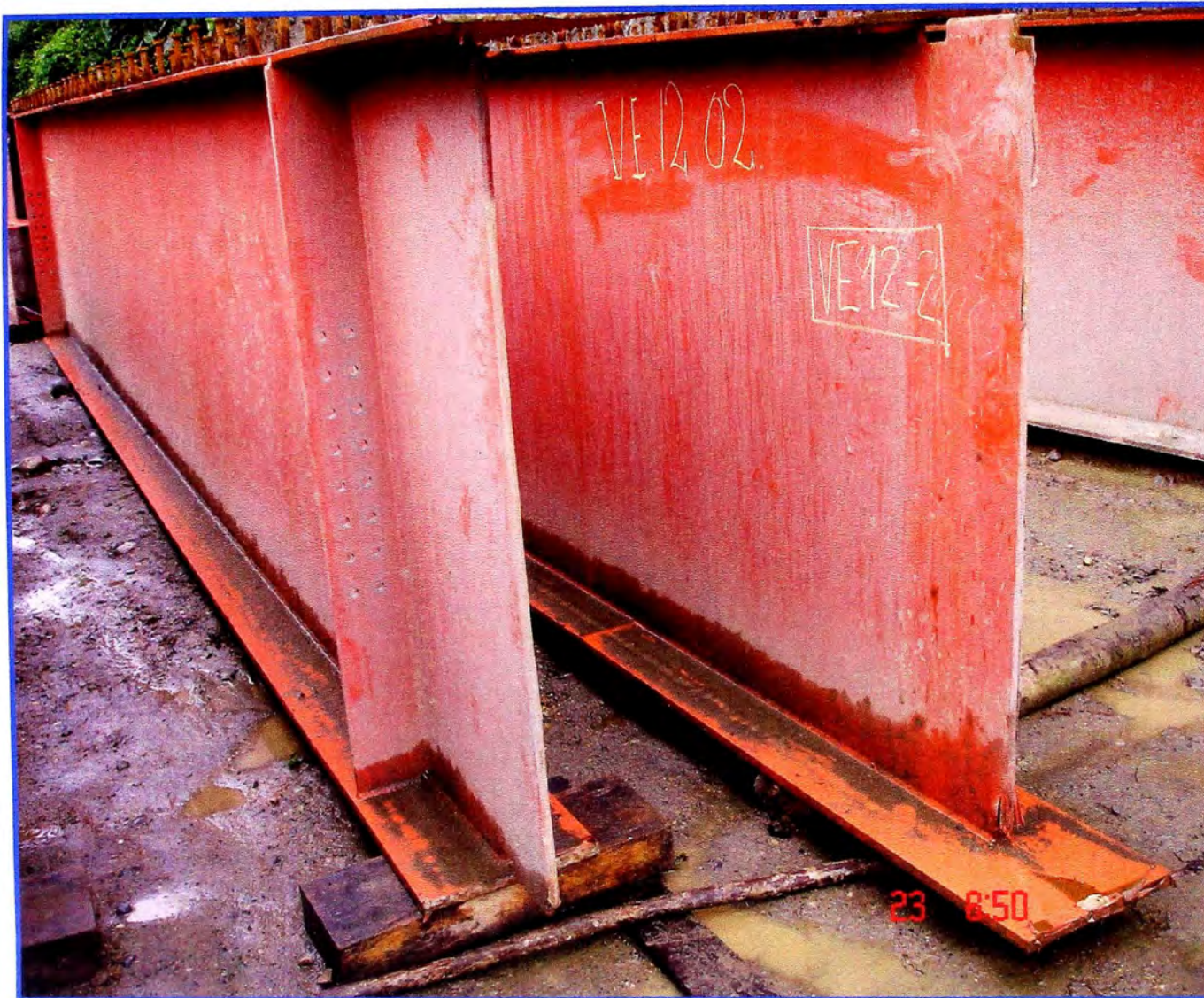
Foto No. A.03.04: Los Tramos de Vigas son Fabricados para que los Empalmes en Obra sean en “Z”.
