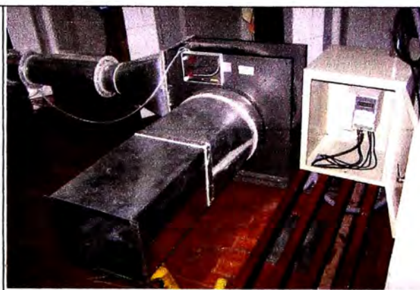
Ubicación del ventilador y del variador de frecuencia.
