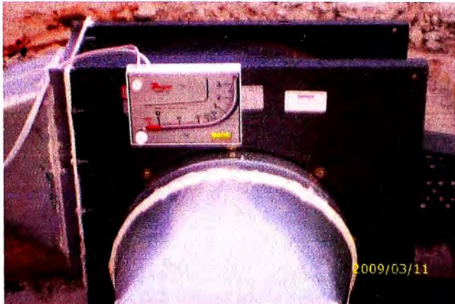
Instalación y ubicación del manómetro
