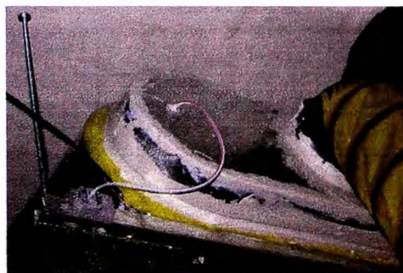
Ubicación del termostato que medirá la presión dentro de la Ductería.
