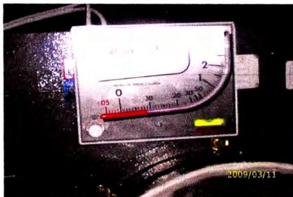
Manómetro indicando un valor de 0,085 w.c.a (foto tomada en un momento distinto al de la anterior foto)
