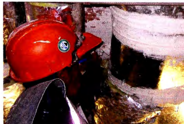
Personal resanando el sellado donde se localizó algunas fugas.
