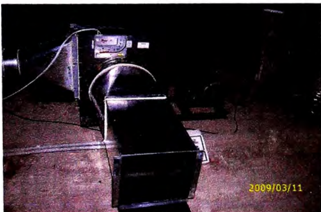
Ventilador conectado al variador de frecuencia lado derecho su erior
