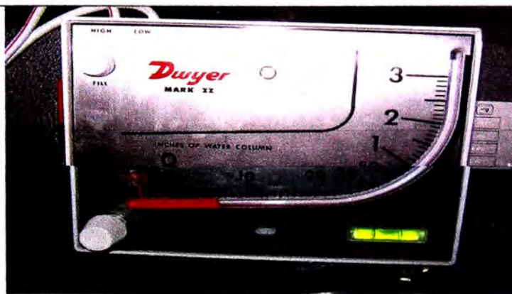
Manómetro en plena prueba indicando el valor de 0,06" w.c.a.
