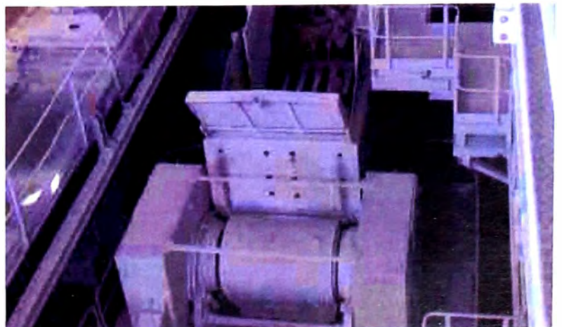
Una C200 tras la sustitución de una trituradora de mandíbulas de doble placa basculadora. Se ha aumentado la capacidad de la planta sin necesidad de modificar la cimentación.
