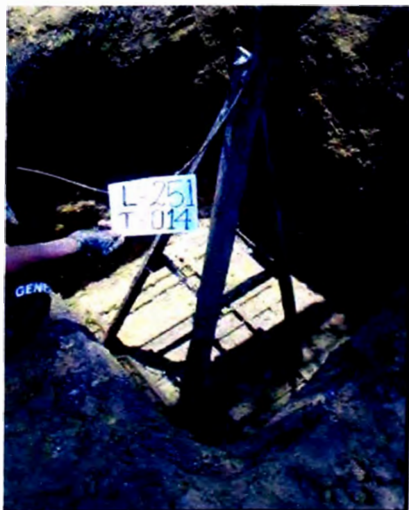
Línea 2251 / Torre N° 014 / Elemento: Perfiles del castillo Embudo permanece en 5 %
