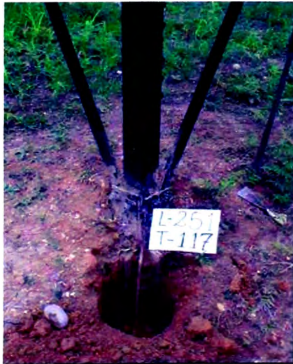
Línea 2251 / Torre N° 117 / Pata N° 04 / Corrosión Nivel 2
