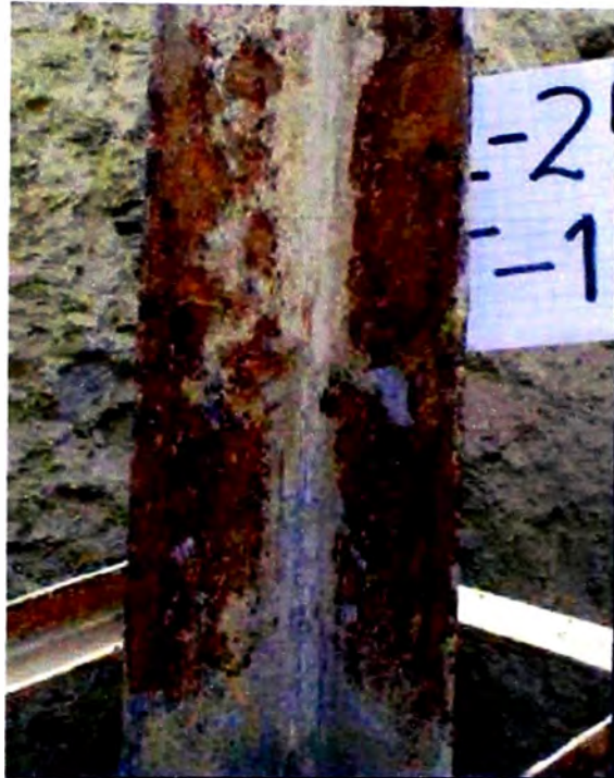
Línea 2252 / Torre N° 171, Pata seleccionada N° 04 Elemento: Perfiles del castillo Corrosión Nivel 5 (10%) Nivel 4 (20%) Nivel 3 (70%)
