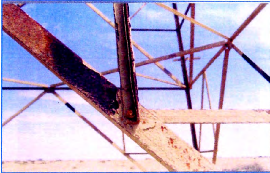
Nivel de Corrosión 5
