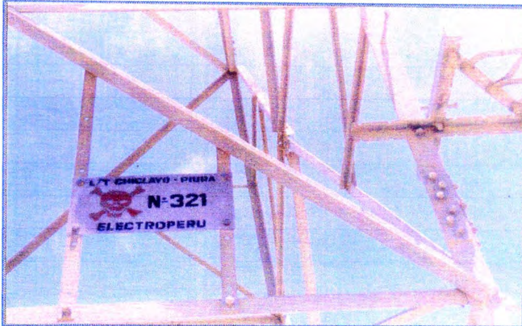
Nivel de Corrosión 1
