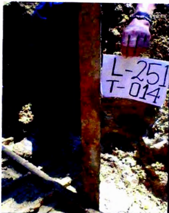
Línea 2251 / Torre N° 014, / Pata seleccionada N° 01 Elemento: Perfiles del castillo Corrosión Nivel 3 (30%), Nivel 2 (70%),
