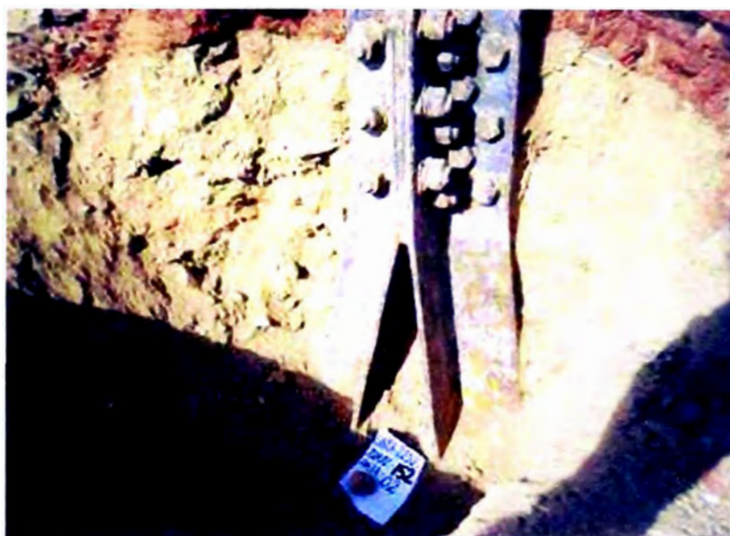
Línea 2252 / Torre N° 152 / Pata N° 02 / Corrosión Nivel 4
