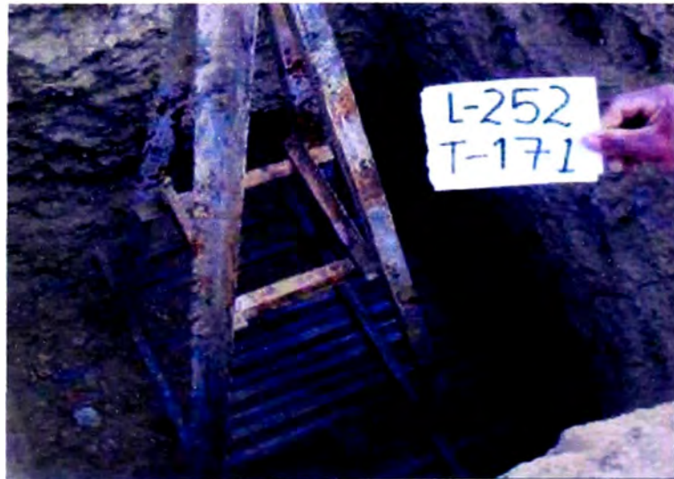
Línea 2252 Torre N° 171 Elemento: Perfiles del castillo Embudo perdido totalmente
