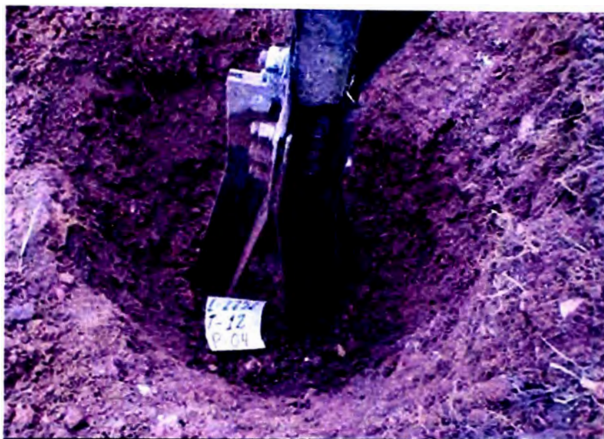
Línea 2252 / Torre N° 012/ Pata N° 04 / Corrosión Nivel 3
